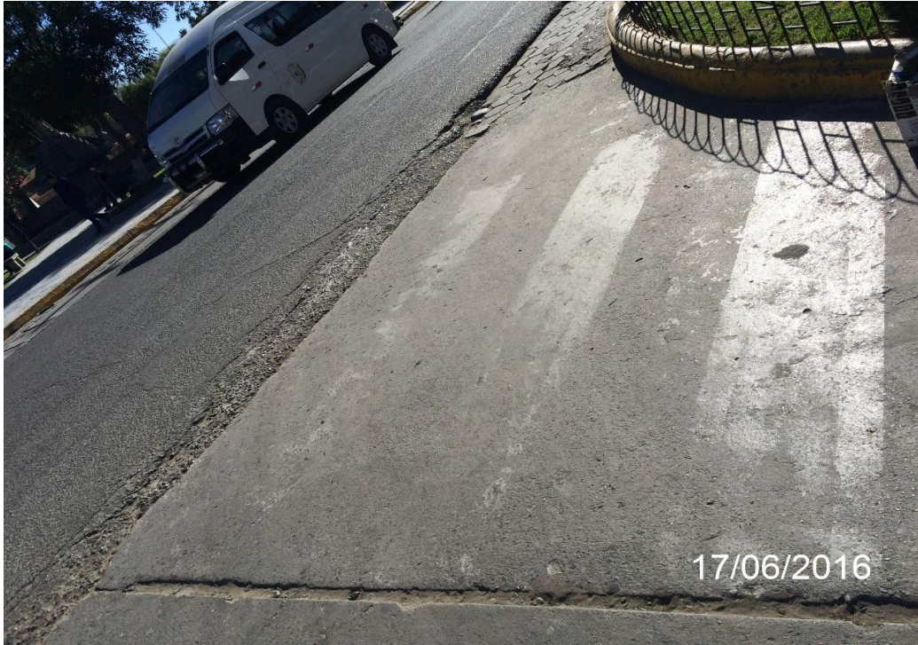
Fotografía 11 - Desgaste en la pintura del cruceo peatonal
