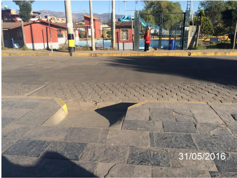
Fotografía 7 - Rampa no conectada con cruceo peatonal
