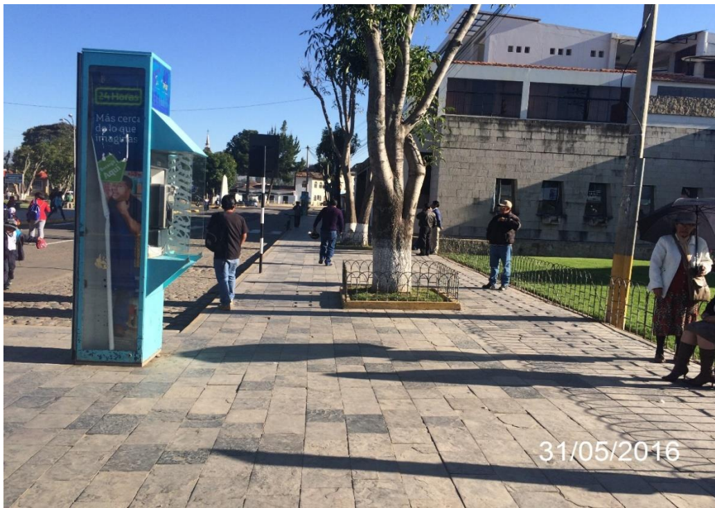
Fotografía 10 - Obstrucciones en la acera A-7
