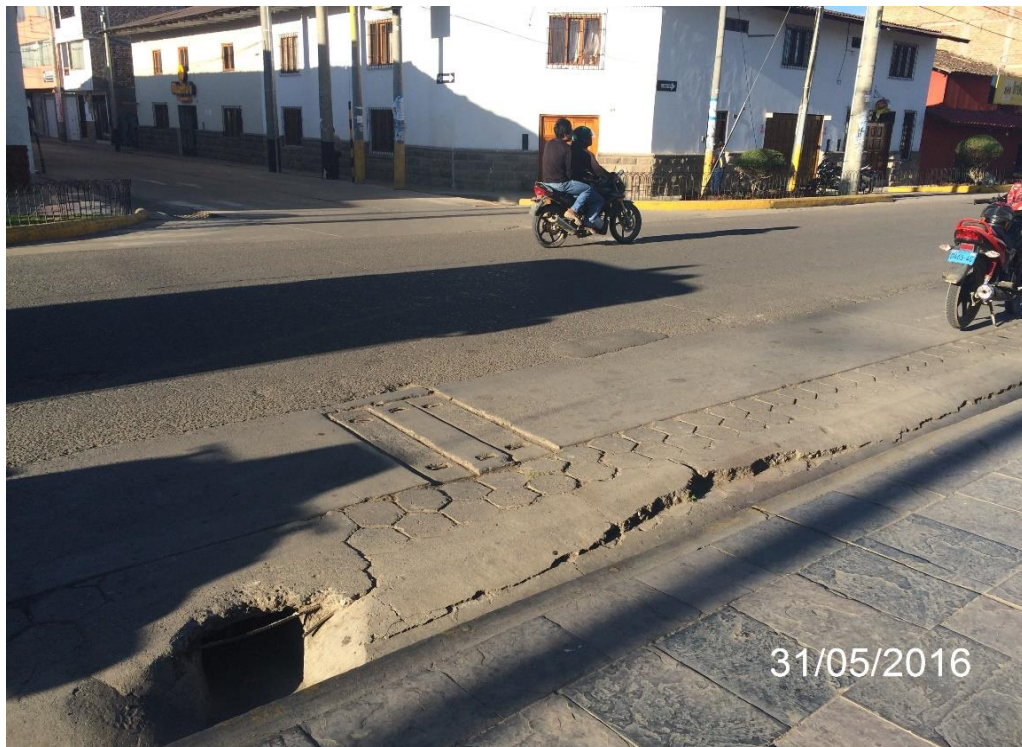
Fotografía 12 - Cruceos con pintura desgastada C-6 y C-7
