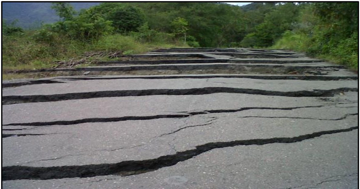
Figura N° 03: Suelos inestables de un pavimento.
