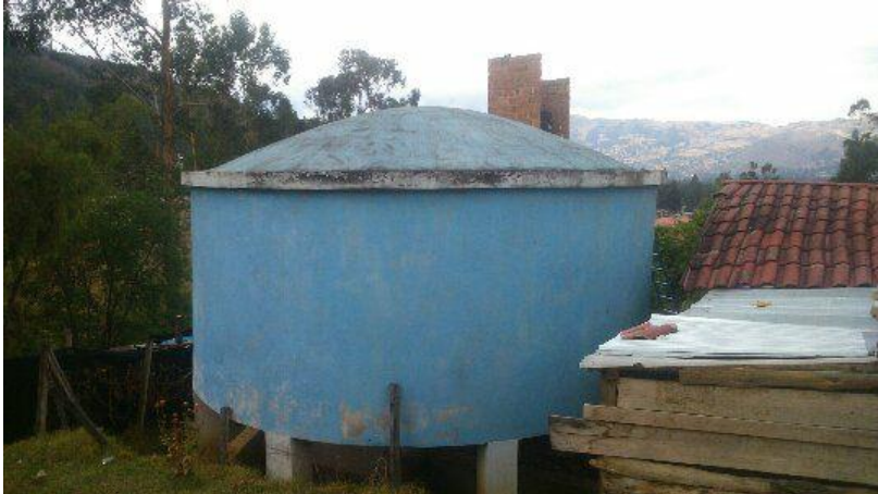
Figura 14: Reservorio para el sector A. Fuente: Elaboración Propia
