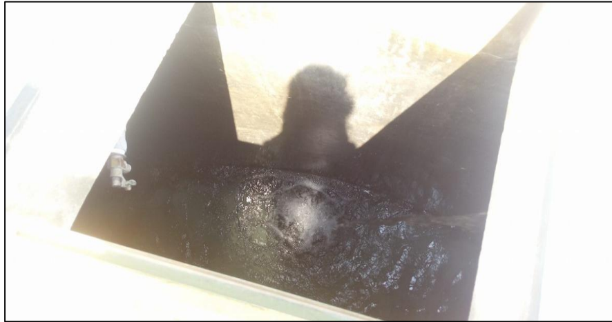
Figura 16: Interior del reservorio y sistema de cloración. Fuente: Elaboración Propia
