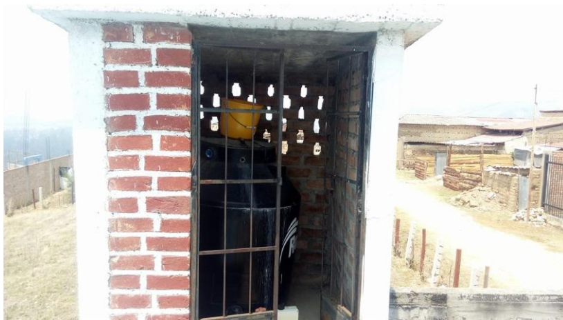
Figura 15: Tanque de almacenamiento de cloro. Fuente: Elaboración Propia
