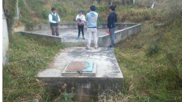
Figura 3. captación de agua
