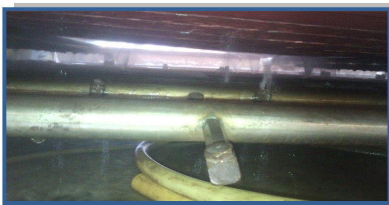
Figura N° 17-3 Zona de tina de enfriamiento.
