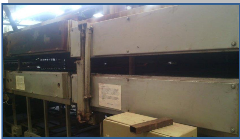
Figura N° 15-3 Zona de horno.
