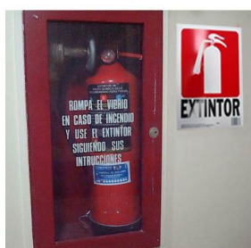
Figura N° 53-3 Señalización de extintores en la zona de trabajo.
