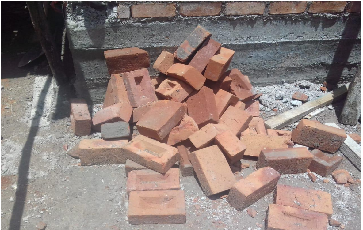
Figura 4: Desperdicios de ladrillo.
