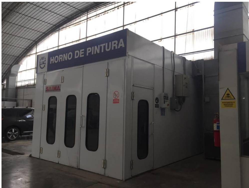
Figura 73. Horno de pintura
