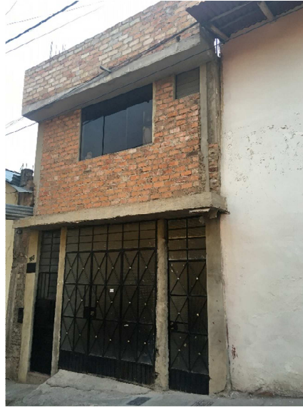
Imagen N° 5: Baja calidad en el diseño y ejecución de edificaciones
