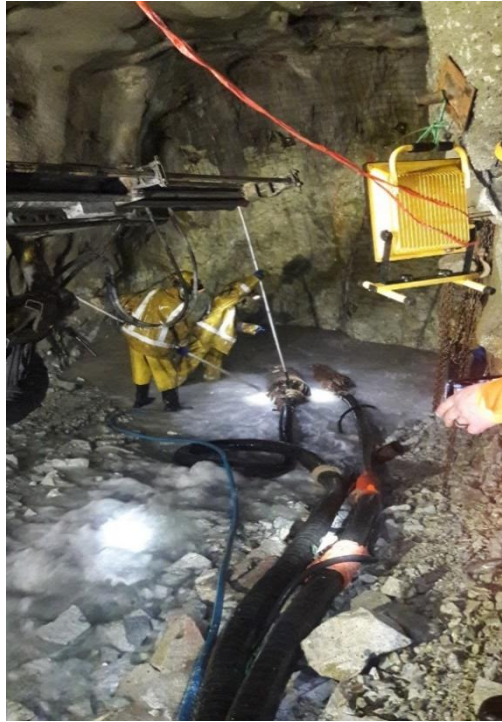
Figura n.º 3.3. Mal uso de las bombas
