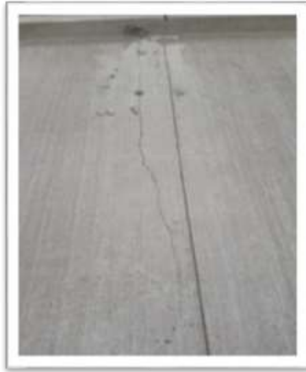
Figura Nº 2. Fisuras en el pavimento de concreto – Av. Pedro Miota
