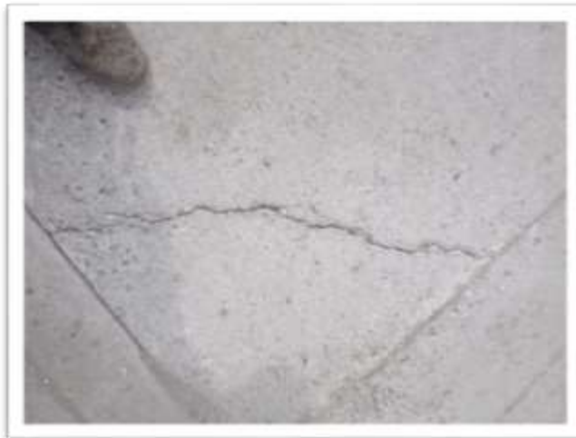
Figura Nº 3. Fisuras en el pavimento de concreto – Av. Pedro Miota
