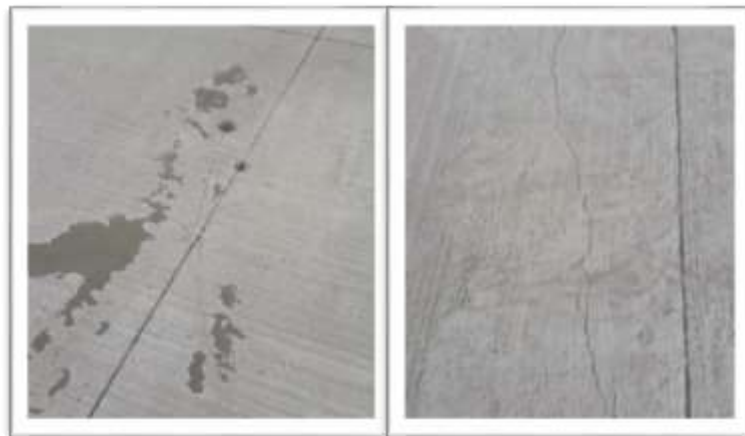
Figura Nº 1. Fisuras en el pavimento de concreto – Av. Pedro Miota
