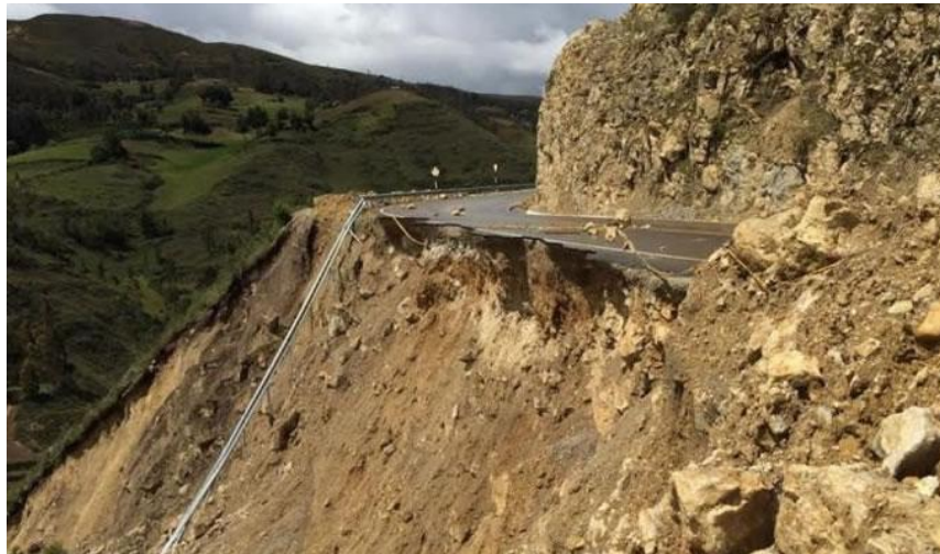
Foto 1. Deslizamiento de rocas, en la vía Celendín - Cajamarca, km 43.
