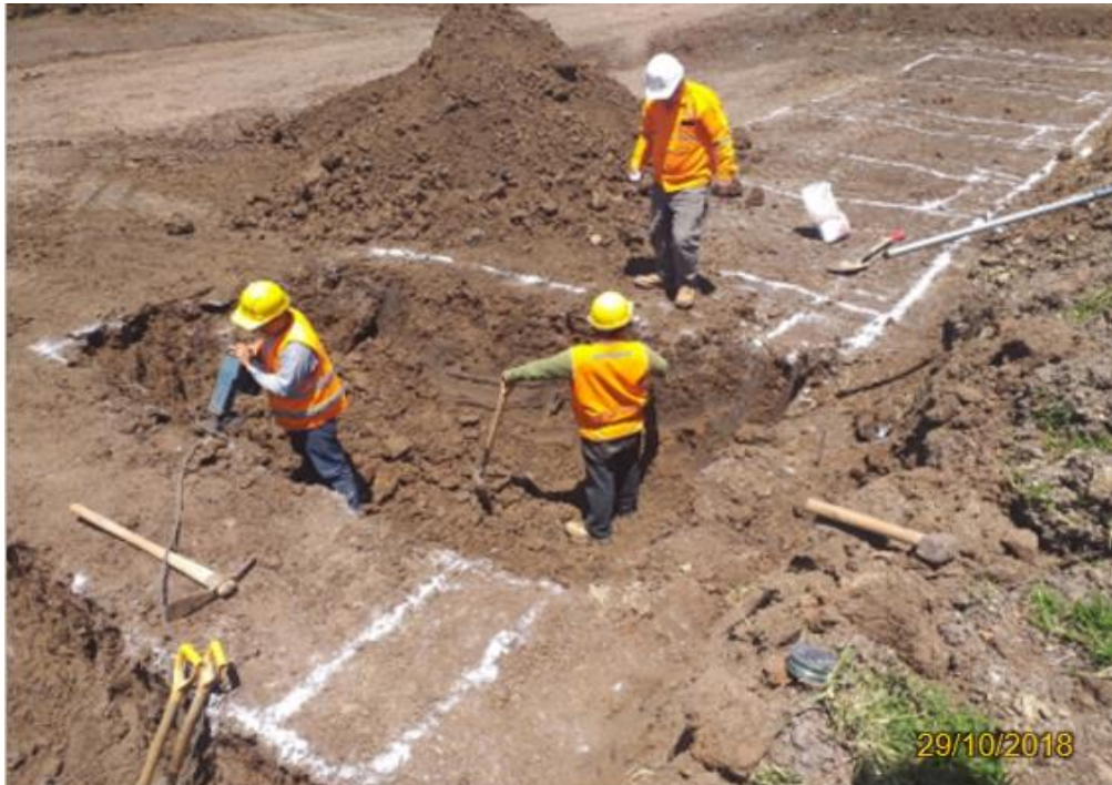
Fotografía 19. Trabajadores sin uso de guantes de protección durante la excavación de cimentaciones.
