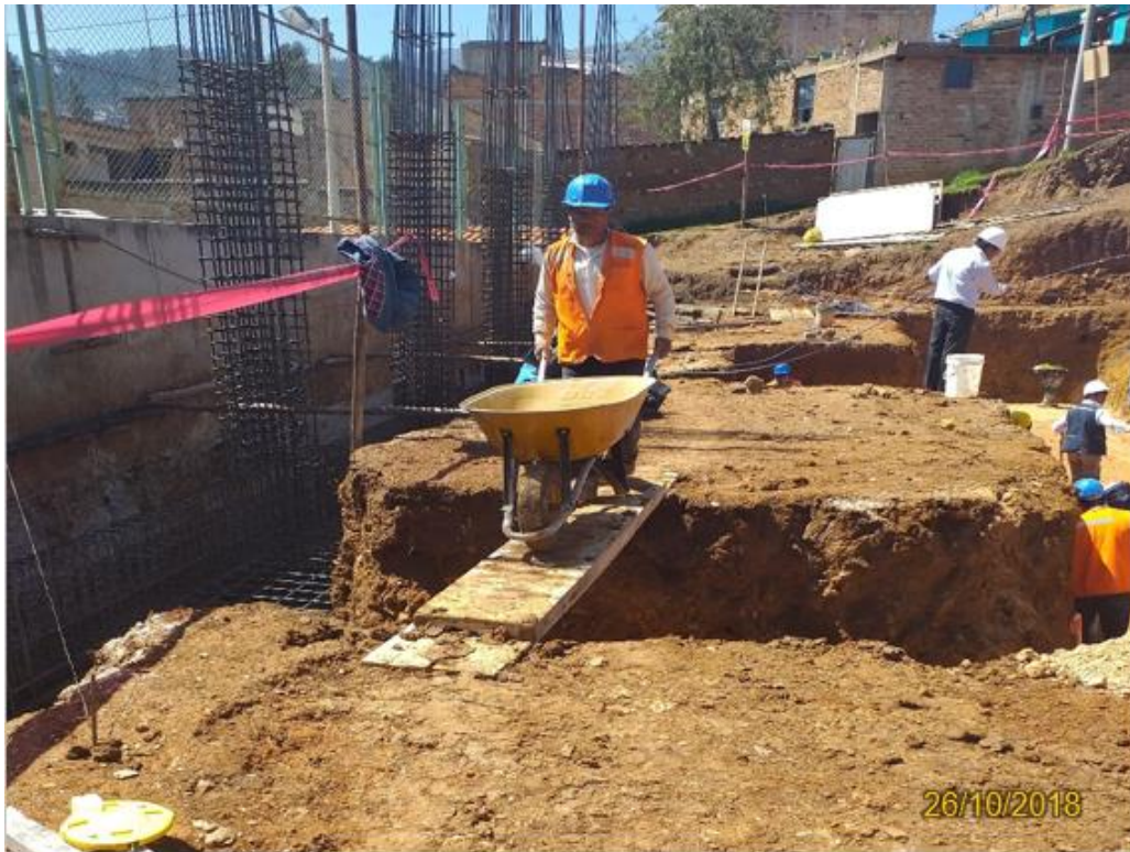
Fotografía 15. Plataforma de circulación sin barandas de protección reglamentarias.
