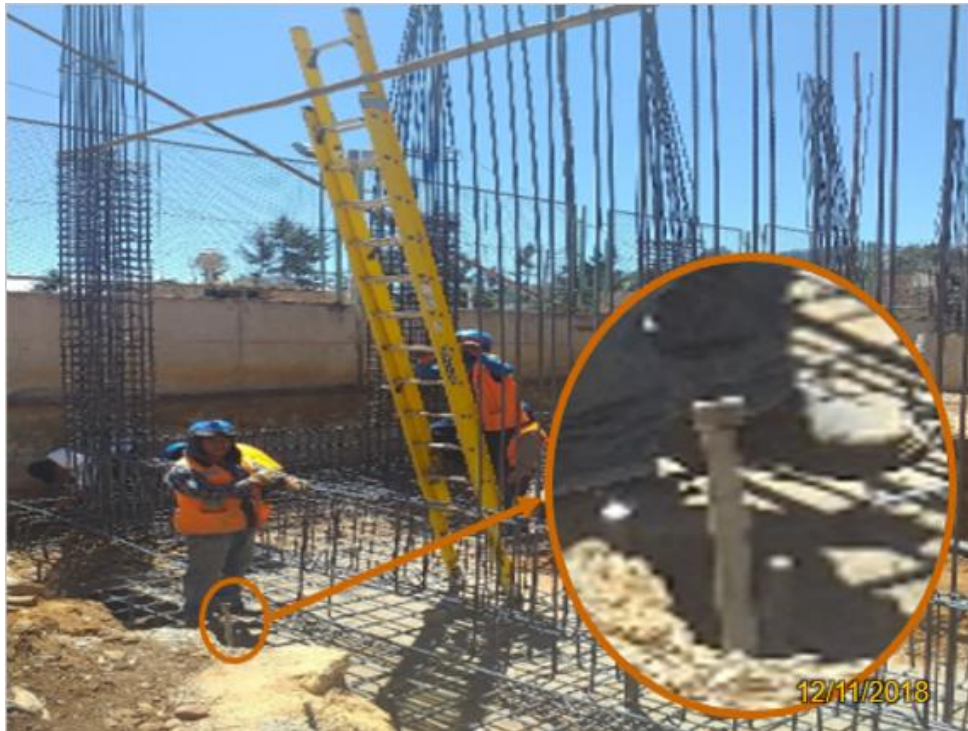
Fotografía 29. Riesgo considerable de politraumatismo severo por punzonamiento y caídas de distinto nivel.
