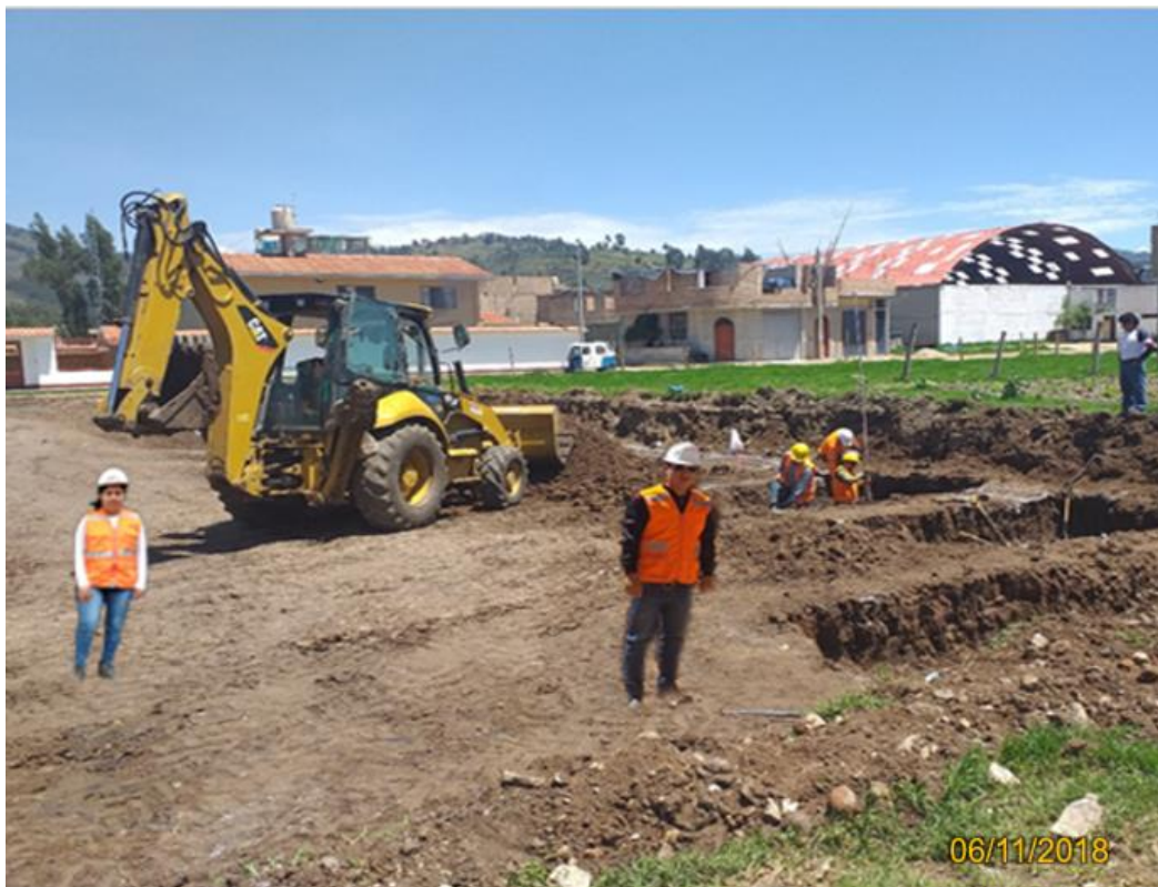
Fotografía 20. Inexistencia de cerco perimétrico para evitar la accesibilidad de personas ajenas al lugar.
