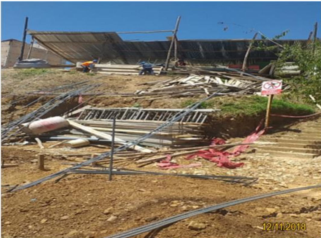
Fotografía 27. Apilamiento de materiales en completo desorden y obstruyendo el paso en el acceso a la obra.
