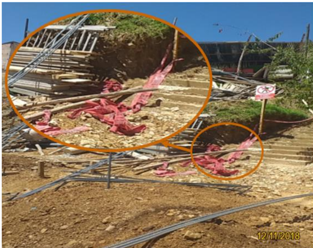
Fotografía 28. Inadecuada mantenimiento de señalización preventiva.
