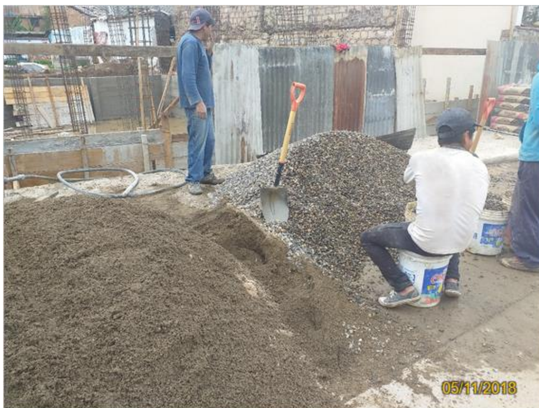
Fotografía 22. Trabajadores sin equipo de protección personal para el vaciado de concreto en cimentaciones.
