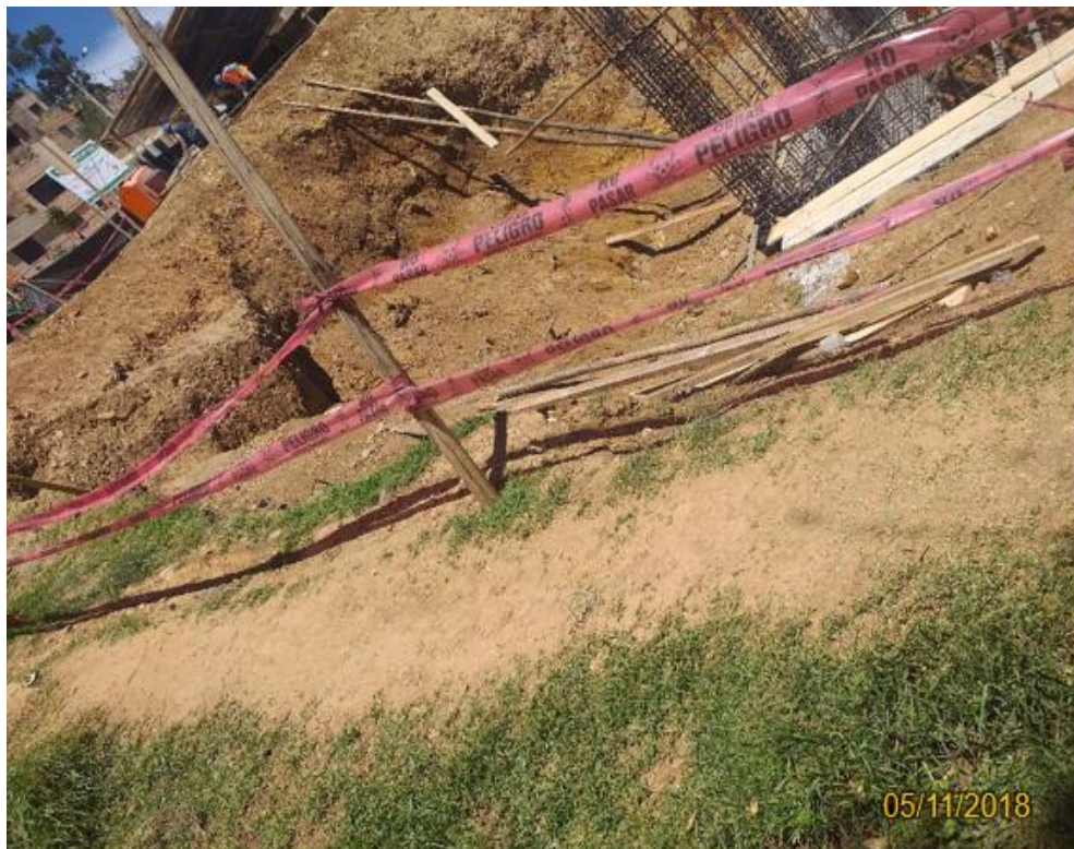
Fotografía 30. No cuenta con un cerco perimétrico para evitar el acceso de personas ajenas a la obra.
