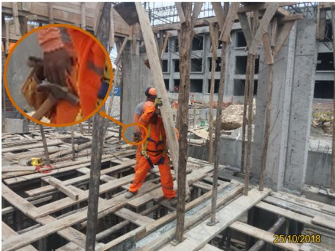
Fotografía 8. Trabajador sin guantes de protección durante el encofrado de losa.
