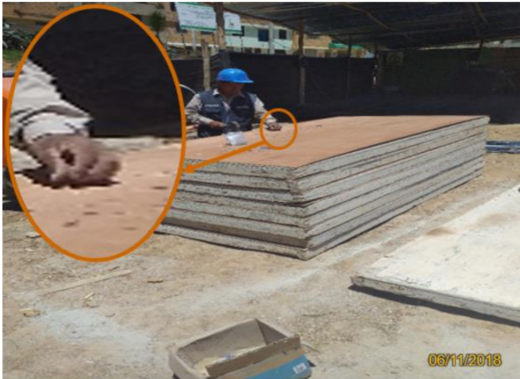
Fotografía 33. Trabajador sin uso de EPP o guantes para el trabajo específico de la obra.
