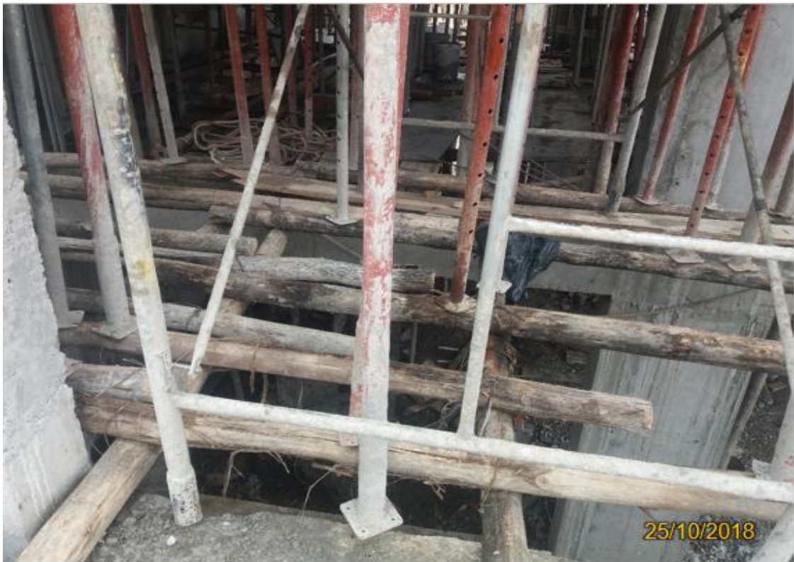
Fotografía 7. Riesgo en la estabilidad de los encofrados por un mal arriostramiento de pies derechos.
