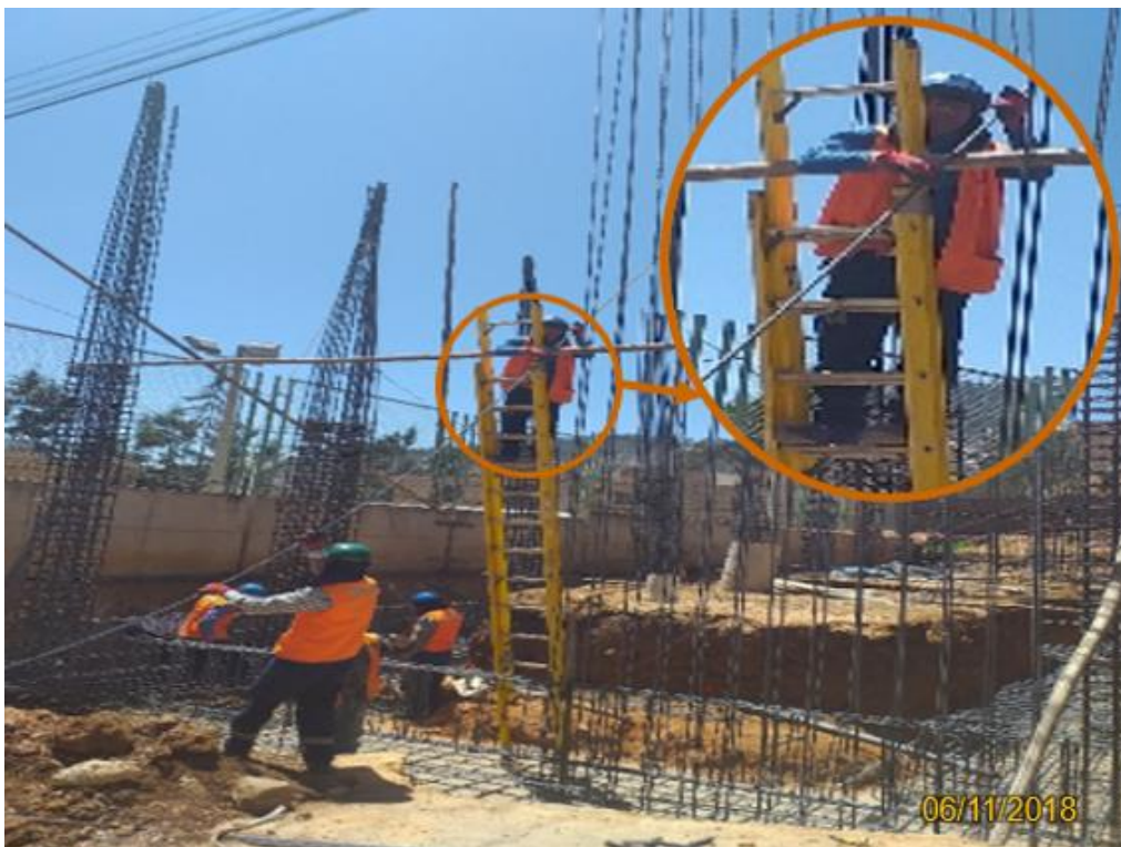
Fotografía 24. Peón en deficiente uso en el manejo de carga en trabajos de altura.
