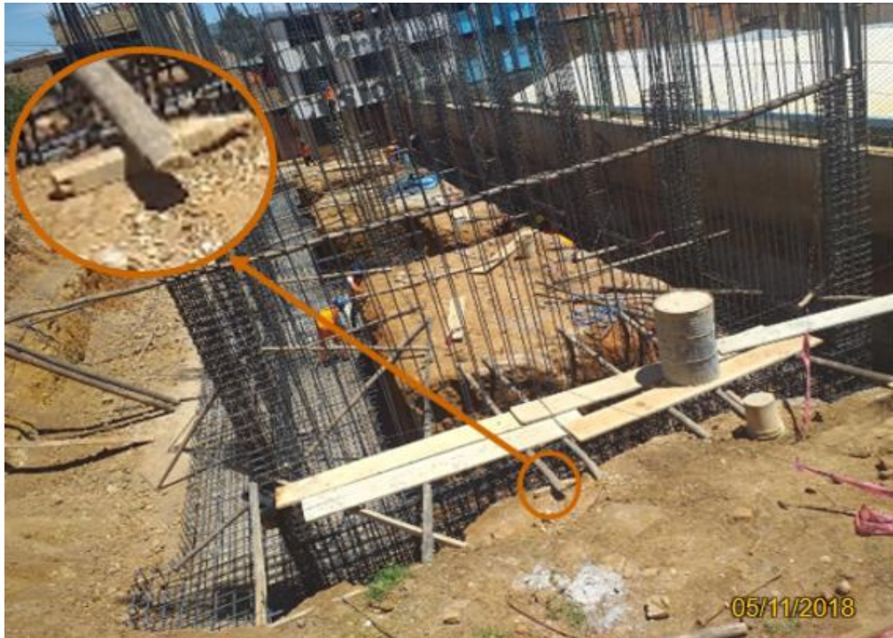
Fotografía 31. Andamios armados de manera inconsistente y sin las condiciones de seguridad ante el riesgo eventual de caídas.
