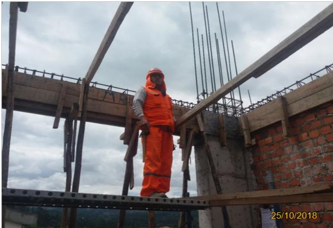
Fotografía 9. Trabajador sin uso de arnés en trabajos de altura.
