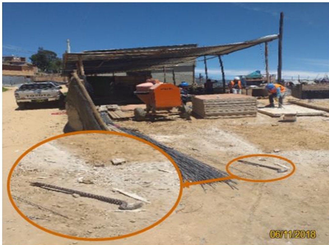
Fotografía 34. Herramientas manuales ubicadas en pasillo obstaculizando la accesibilidad a los trabajos.
