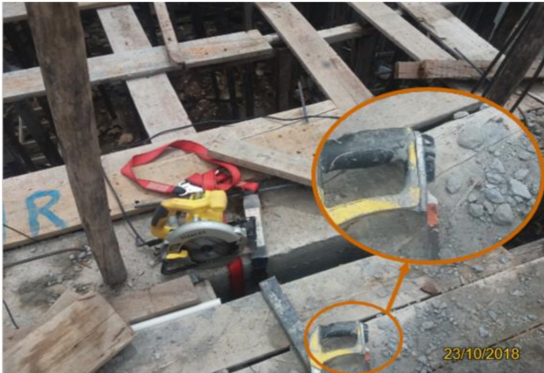
Fotografía 5. Parte agresiva de herramienta de corte (cierra) sin la protección adecuada.
