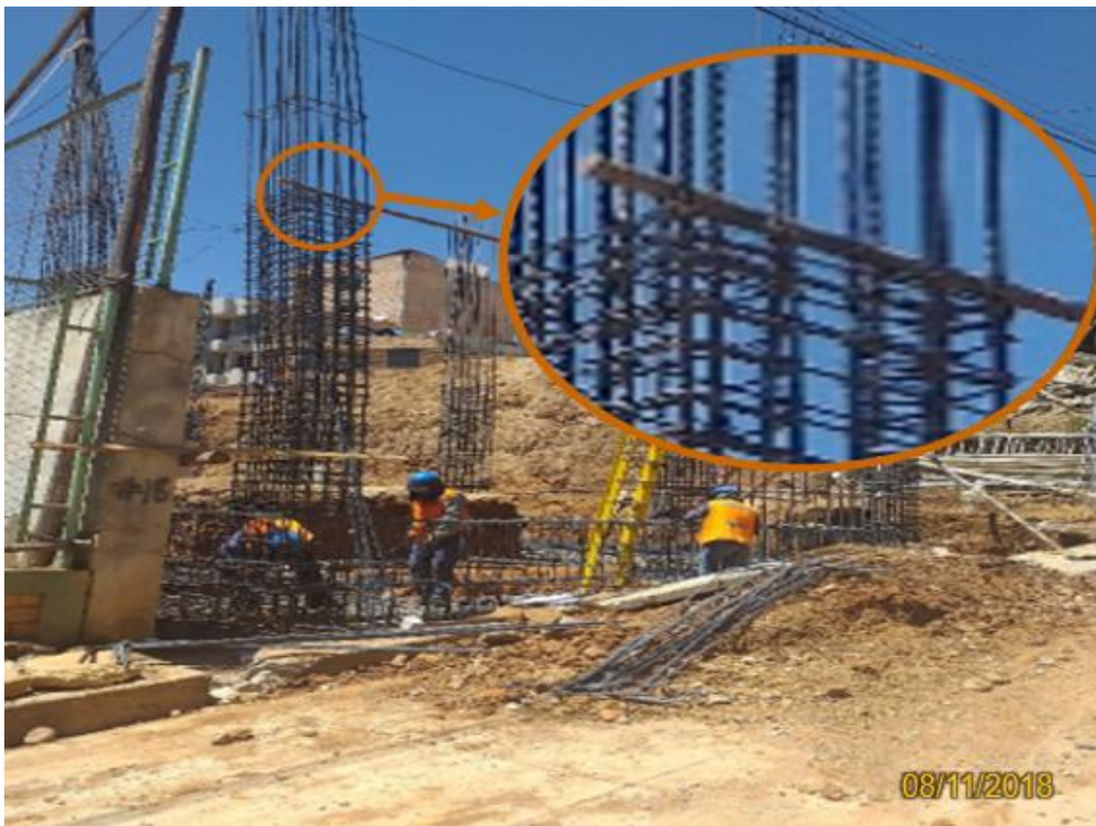
Fotografía 26. No aseguran el pilar horizontal que sirve de anclaje a la escalera.
