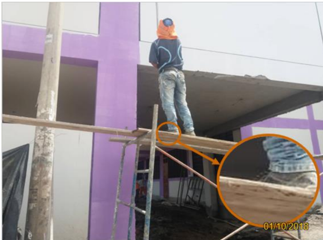
Fotografía 10. Plataforma de andamio de grosor menor al recomendado 2".
