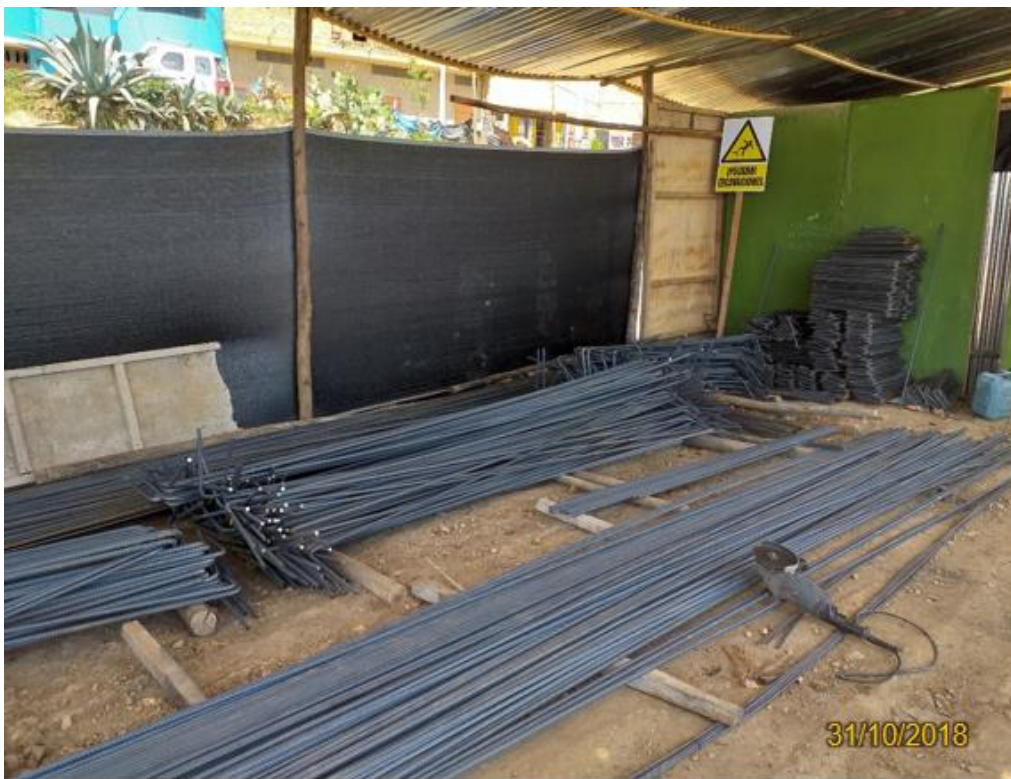
Fotografía 18. Herramienta de corte dejada de manera inapropiada en el lugar de trabajo.
