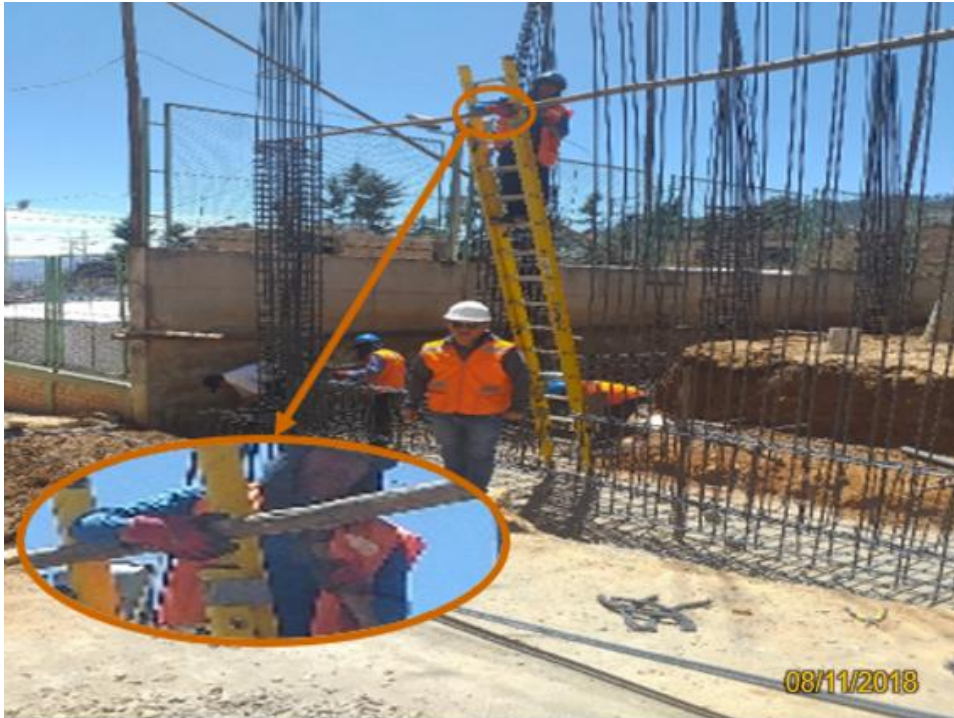
Fotografía 25. La escalera no asegura la estabilidad y sacudidas que se puedan producir al momento de izar el acero.
