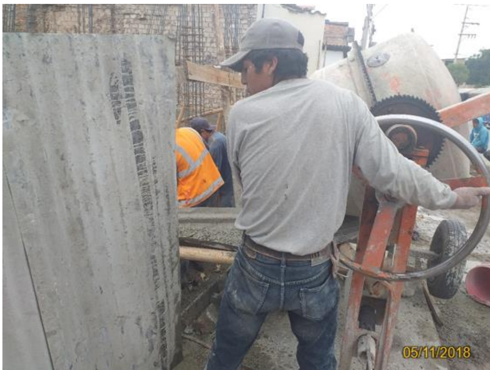
Fotografía 21. Operario sin uso de equipo de protección personal durante la operación de mezclador de concreto.
