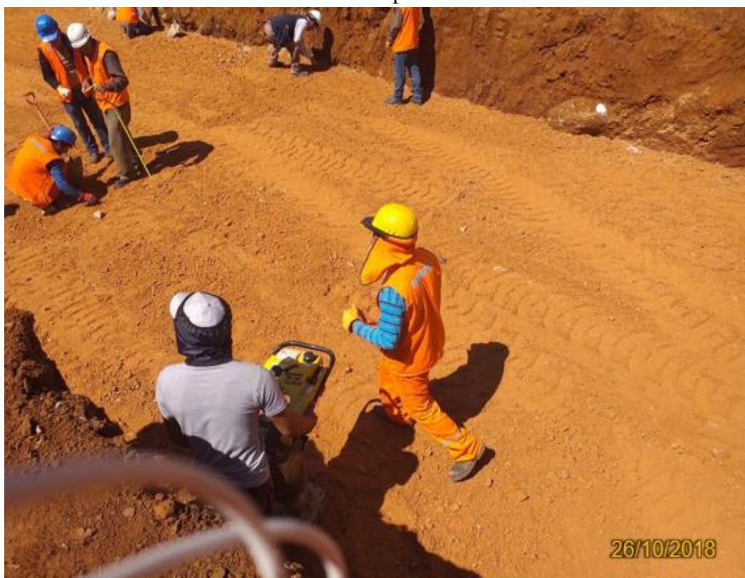
Fotografía 14. Operador de vibro compactador sin equipo de protección personal.
