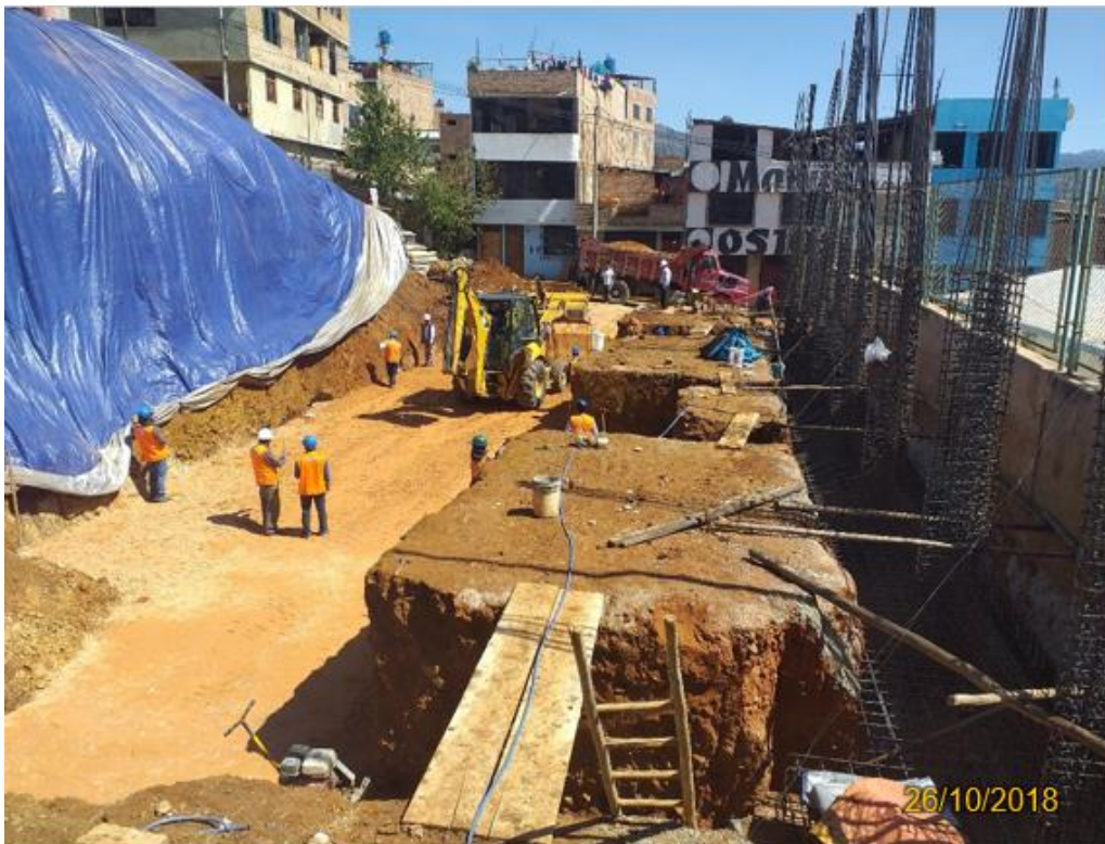
Fotografía 16. Pasadizo de circulación sin la señalización de identificación de peligro.
