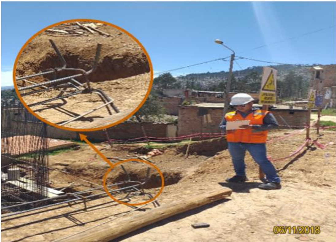
Fotografía 35. Escasa identificación, control y monitoreo del peligro.
