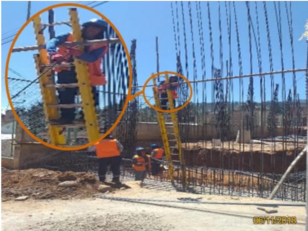
Fotografía 23. Trabajadores sin arnés y anclaje a línea de vida durante trabajos en altura.
