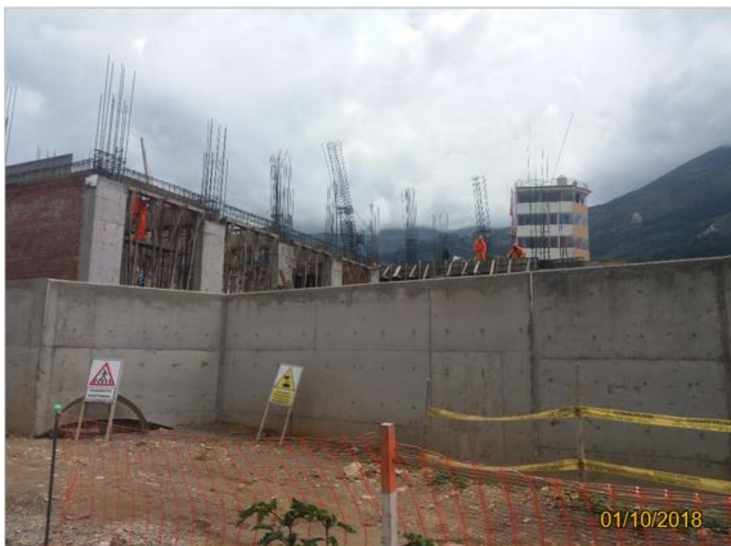
Fotografía 12. Señalización adecuada de zonas de accesibilidad e identificación de peligro.
