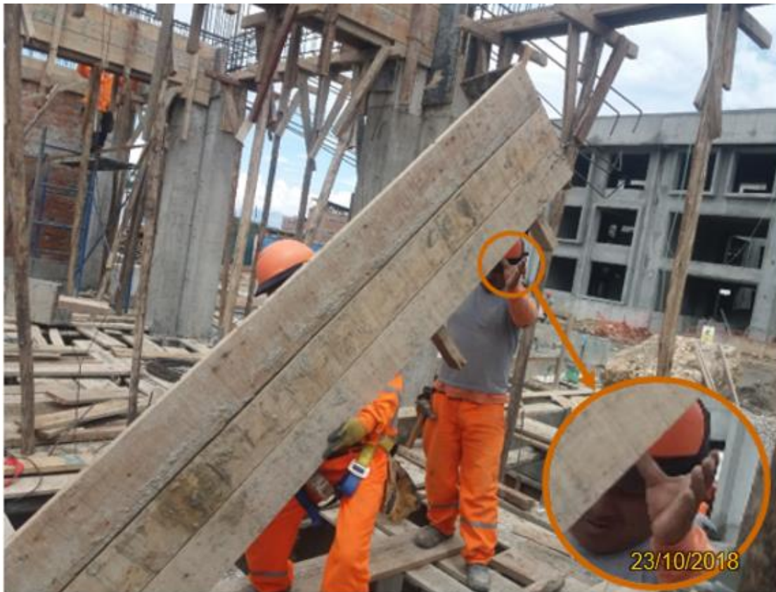
Fotografía 6. No utiliza guantes en trabajo que demanda riesgo de golpe
