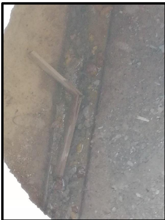
Foto 51: Buzón con presencia piedras, sedimentos
