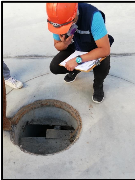
Foto 52: Dificultad de inspección, Jr. Gonzales Prada
