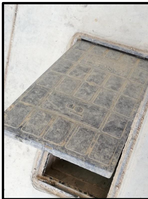
Foto 47: Otra toma, tapas de cajas de inspección
