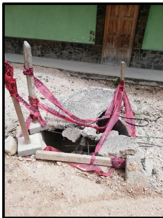
Foto 61: Mejor vista de buzón dañado
