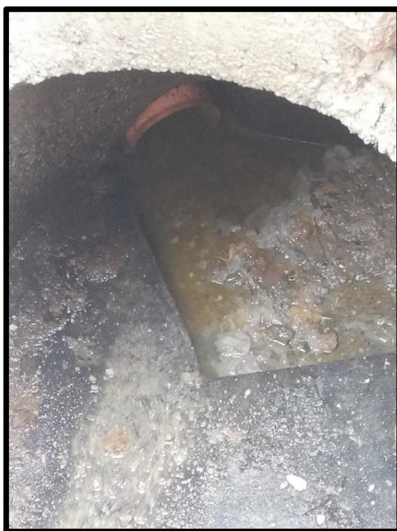
Foto 28: Vista interior buzón, presencia de residuos sólidos y sedimentos
