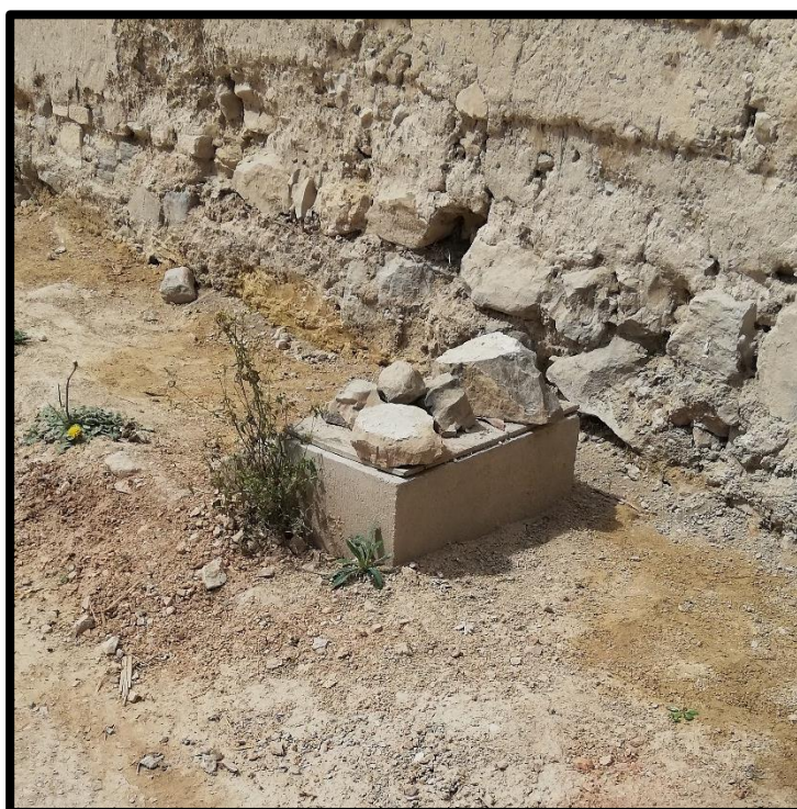
Foto 22: Caja inspección sin tapa, Jr. Raymondi
