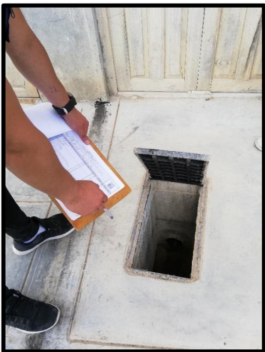
Foto 44: Cajas de inspección, Jr. Gonzales Prada
