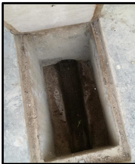
Foto 11: Caja de inspección en buen estado
