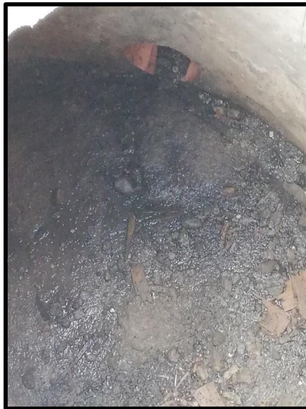
Foto 49: Buzón con presencia de grasas y sedimentos
