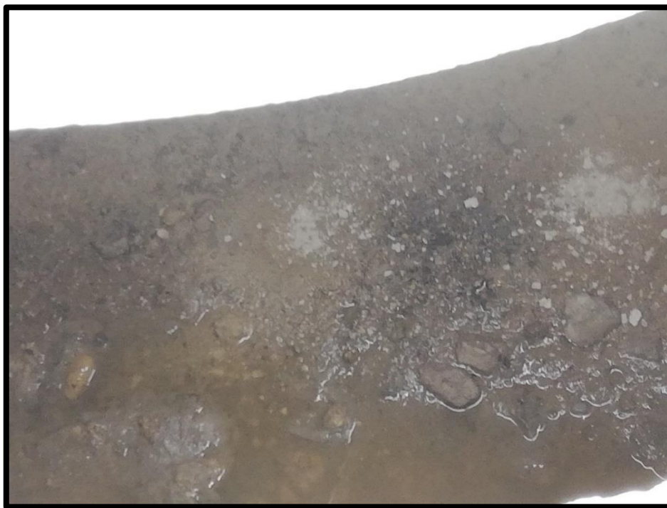
Foto 32: Inspección buzón, presencia de arenas y piedras en el fondo buzón
