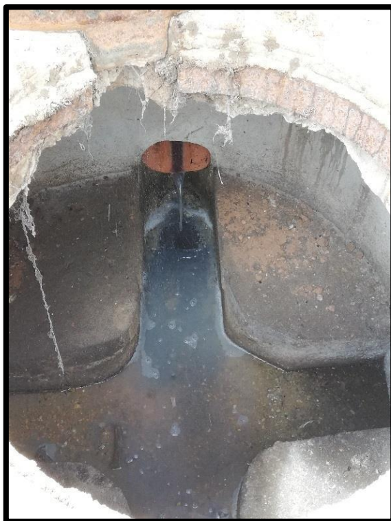
Foto 9: Vista interior de buzón recolector, Jr. Pról. Atahualpa
