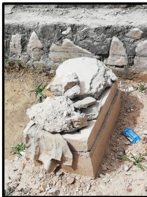
Foto 21: Caja inspección cuerpo dañado, Jr. Bolívar
