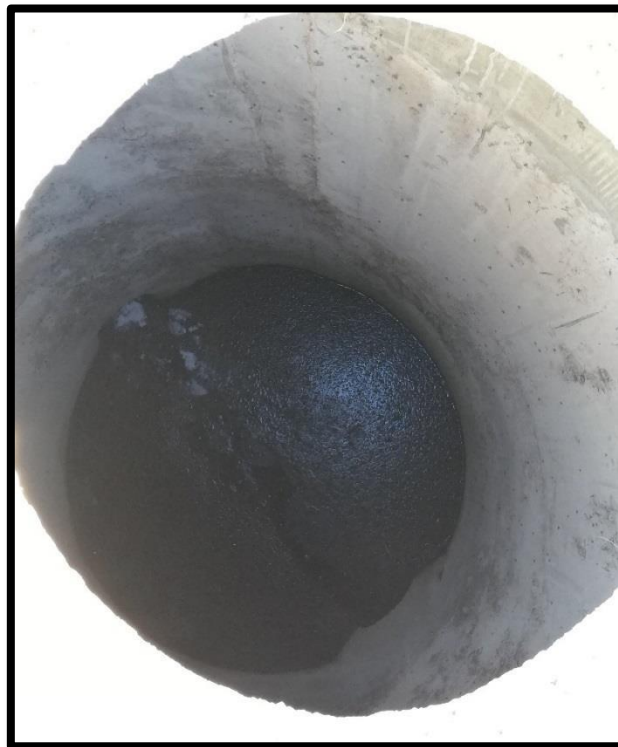
Foto 55: Buzón con altura mayor a 2 metros, presencia de sedimentos
