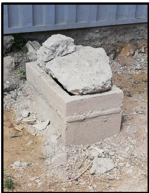
Foto 20: Caja inspección sin tapa, Jr. Huayna Cápac
