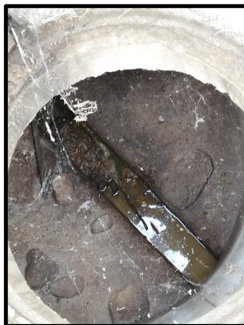
Foto 16: Presencia de sedimentos, raíces. Jr. Atahualpa
