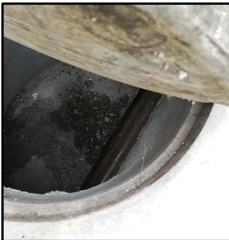
Foto 36: Buzón nuevo con presencia de piedras, Jr. Gonzales Prada
