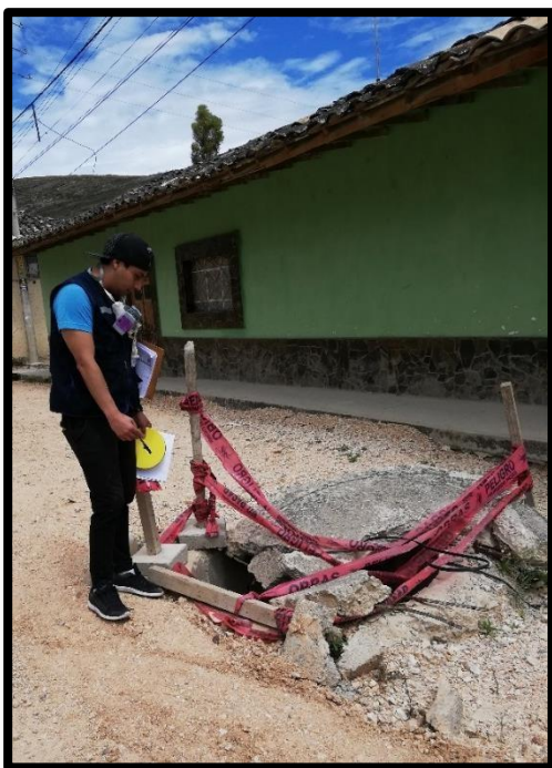
Foto 60: Buzón dañado, Jr. Atahualpa
