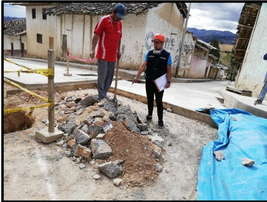
Foto 42: Buzón Relleno material inapropiado, intersección Jr. Bolívar y Jr. Gonzales Prada
