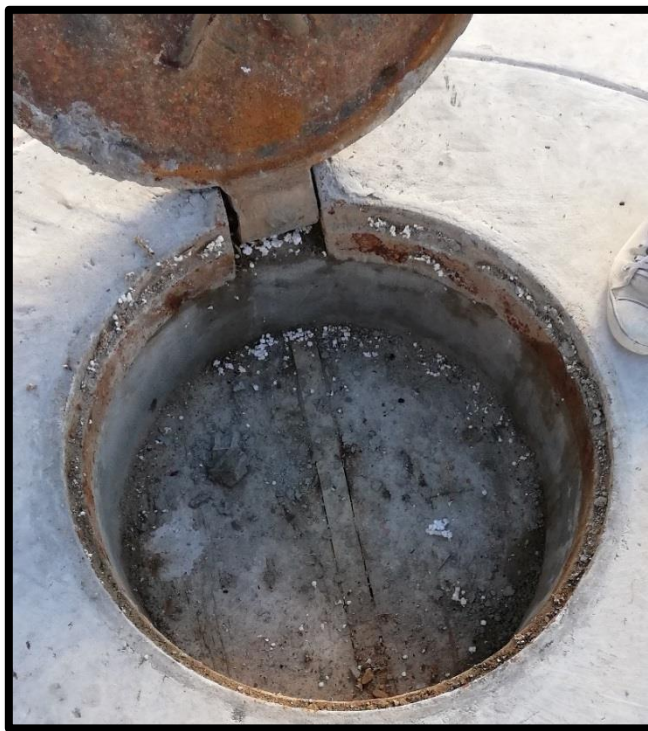
Foto 56: Buzón con dificultad de inspección, Jr. Gonzales Prada
