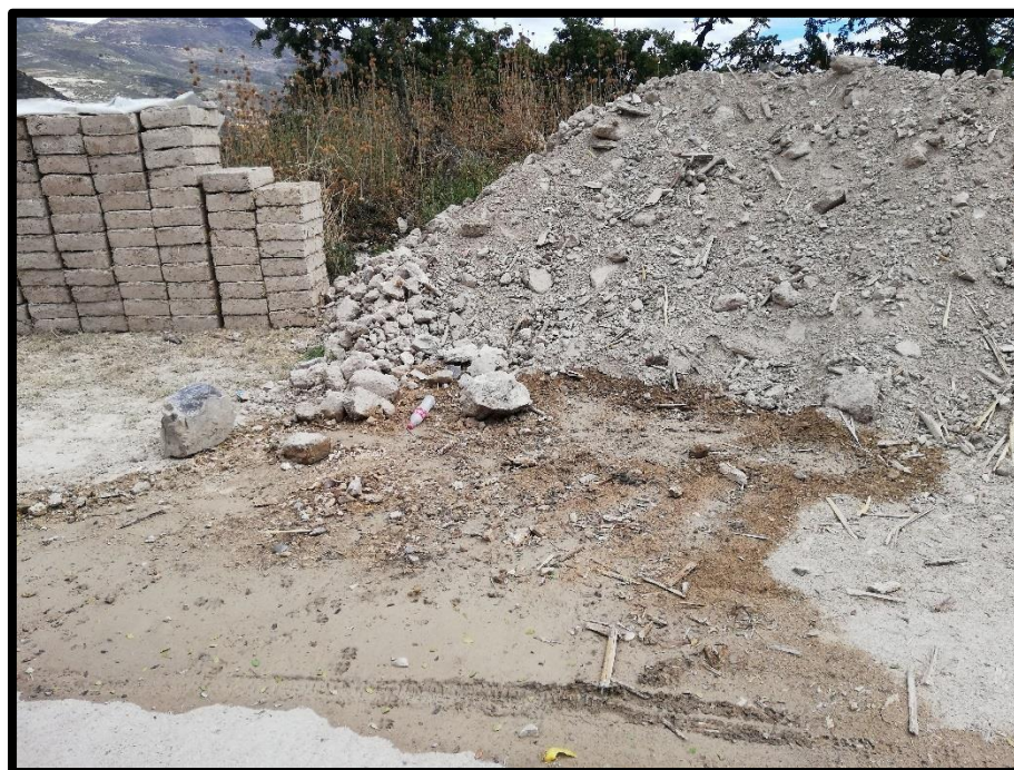
Foto 4: Buzón cubierto con desmonte, dificulta la inspección, Jr. Ricardo Palma
