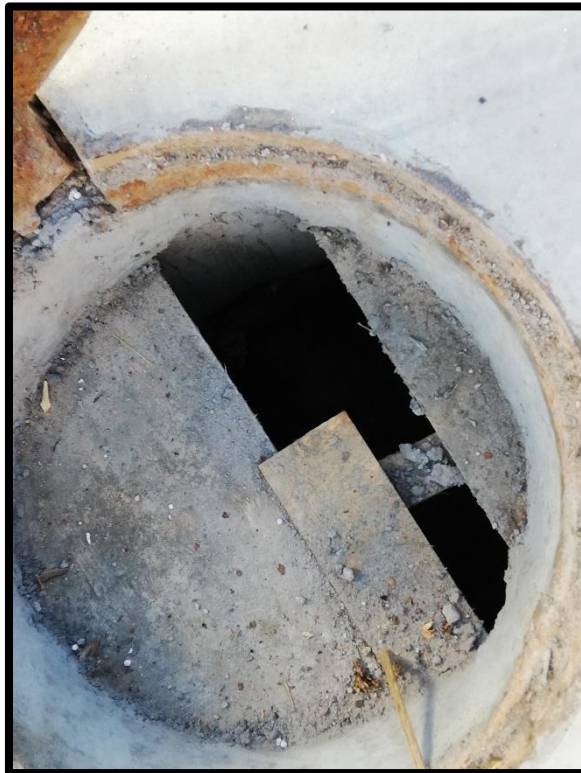
Foto 53: Encofrado de techo de buzón, no retirado
