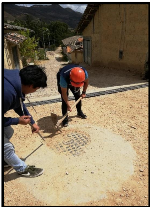
Foto 7: Limpieza tapa buzón, Jr. Pról. Atahualpa
