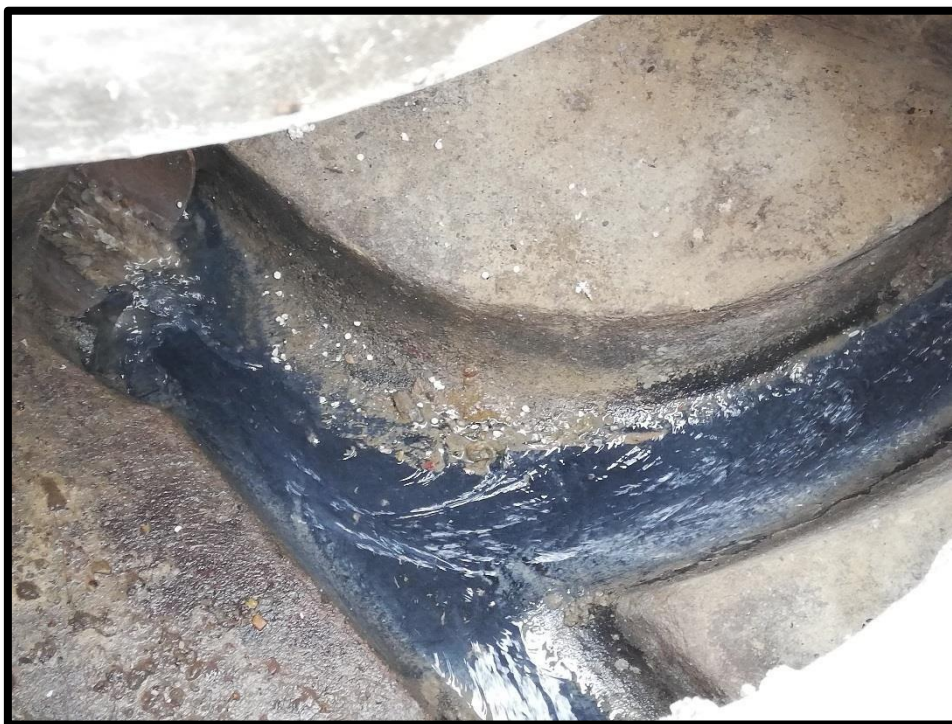
Foto 38: Vista interior buzón de arranque
