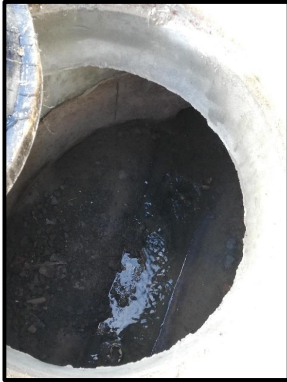
Foto 54: Buzón con presencia de raíces, sedimentos y piedras
