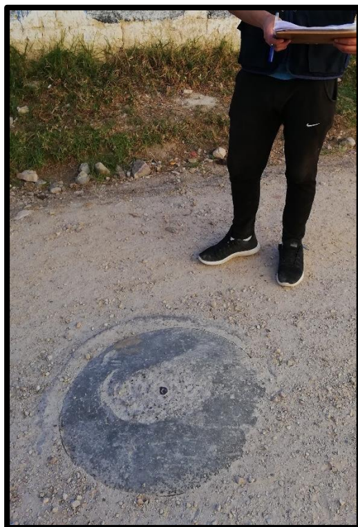
Foto 59: Buzón de arranque, Jr. La Colpa
