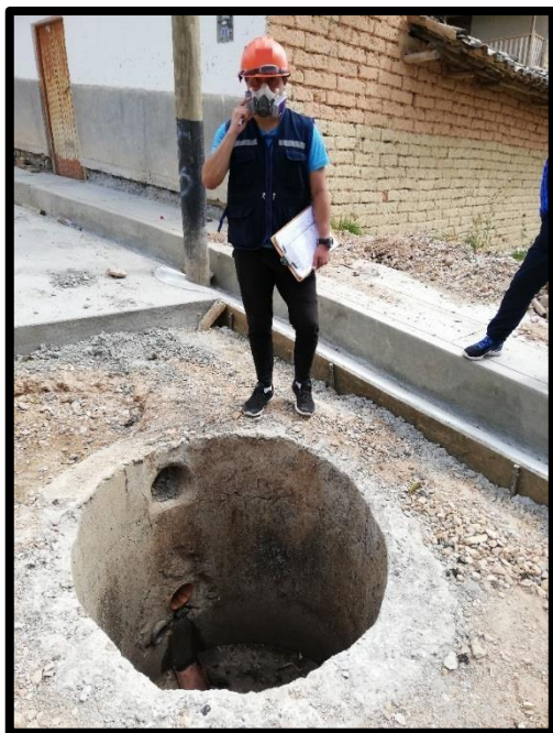
Foto 40: Buzón sin tapa ni techo, Jr. Bolívar
