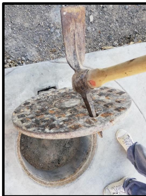
Foto 58: Buzón sin inspeccionar, tapa metálica.
