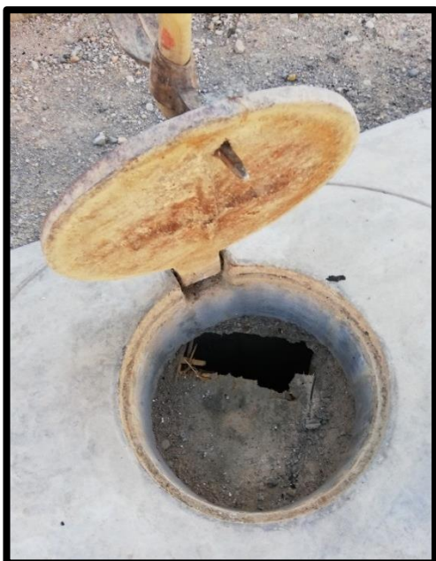
Foto 57: Encofrado de techo de buzón sin retirar
