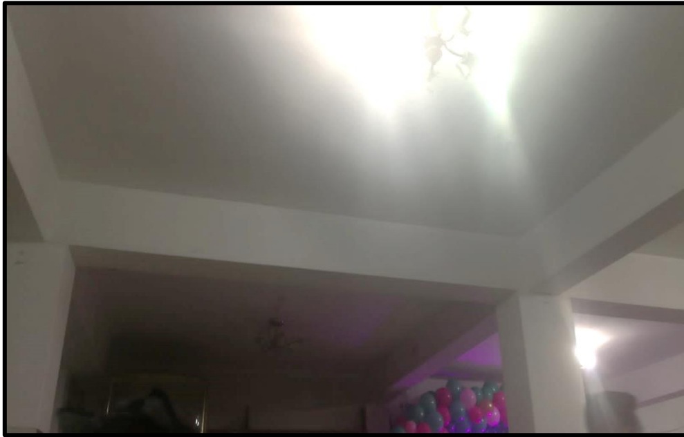
Figura 2: Pórtico eje 3 – B, C. Viga de .25x.40 del eje 3 – B, C apoyada en columnas de 0.25m. x 0.30m. en buen estado estructural.
