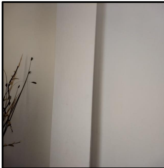
Figura 3: Columna de .25 x .30m. en buen estado estructural, ubicación y medidas según plano existente.
