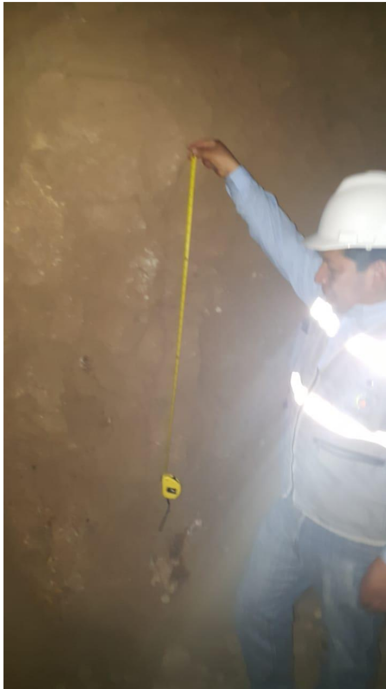
Figura 26 Número de fracturas en Caja Techo Fuente: Elaboración propia
