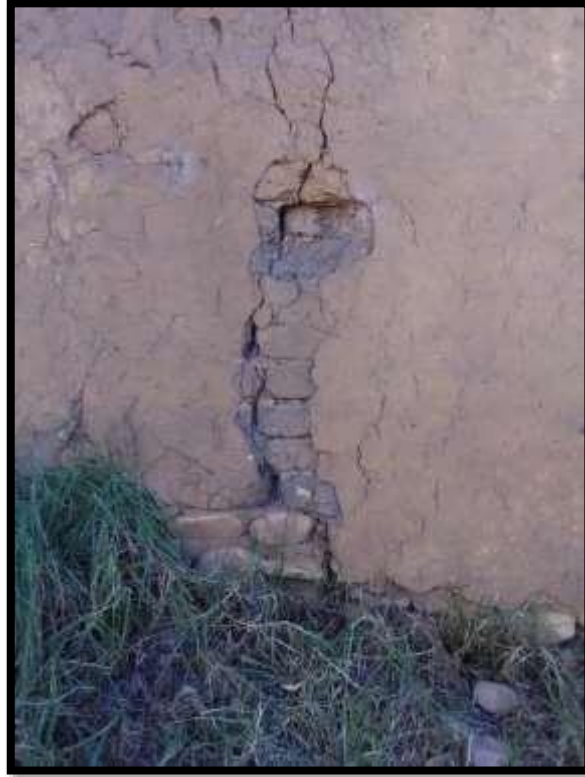
Figura 43: Grietas en mitad de muros.
