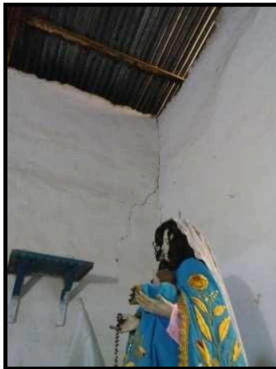
Figura 42: Grietas diagonales en unión de paredes.
