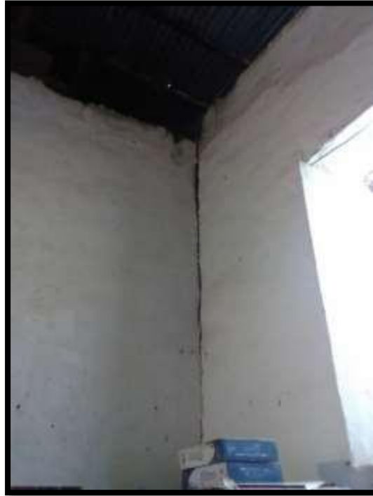
Figura 41: Grietas verticales en unión de paredes.
