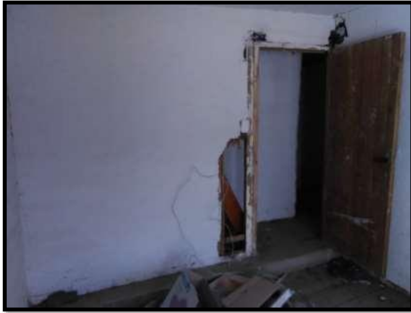
Figura 45: Deterioro de paredes.
