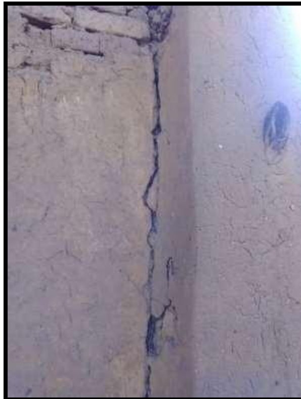
Figura 44: Grietas en la parte exterior.
