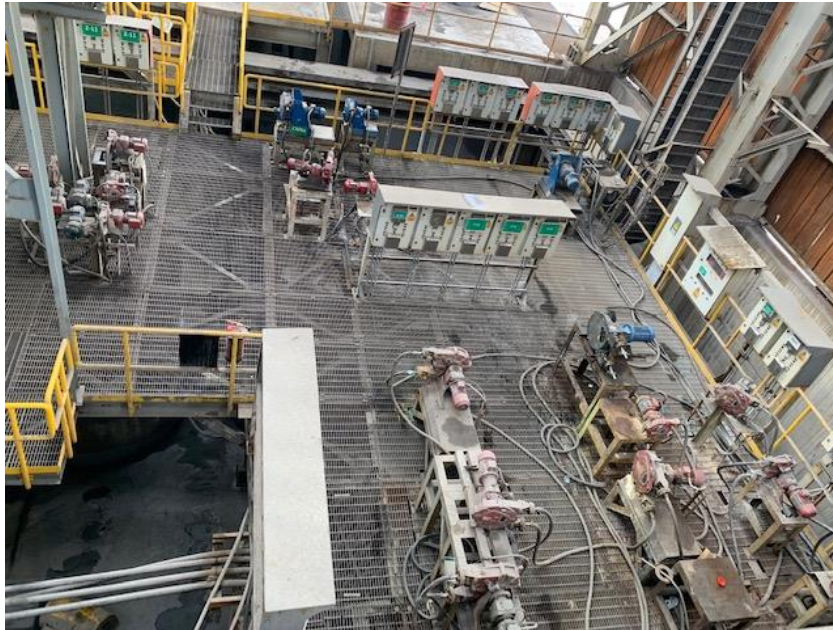
Figura 10: Equipos para el proceso de dosificación de reactivos Elaboración propia
