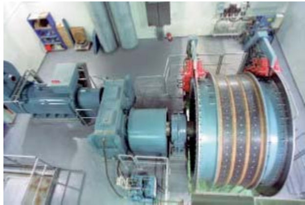
Malacate de producción con un motor de inducción de 1600 kW (Fuente: ABB).
