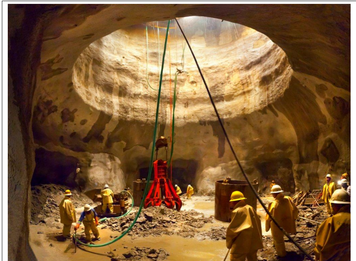
Obras de apertura de nivel como paso intermedio a la continuación de la profundización del pozo.
