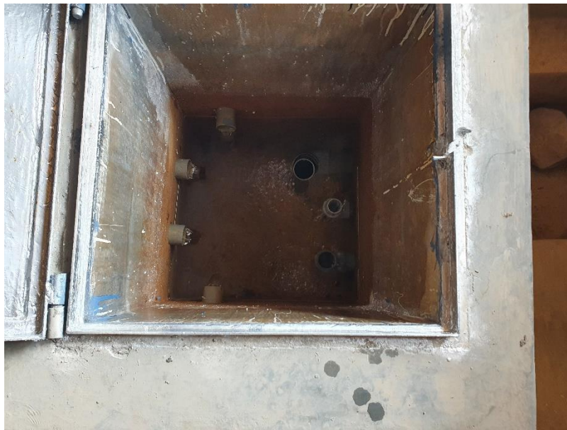
Figura. 58. Tuberías destinadas para cada sector.
