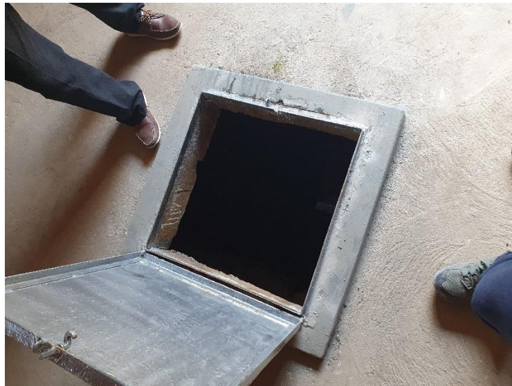
Figura. 59. Cámara húmeda de captación manantial Moyococha. Fuente: Propia.
