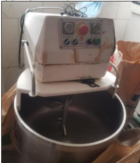
Figura 16 Equipos de panadería con fallas de funcionamiento.
