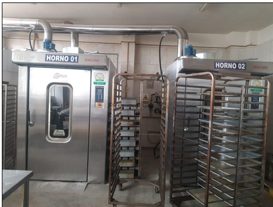
Figura 2. Equipos de la panificadora.
