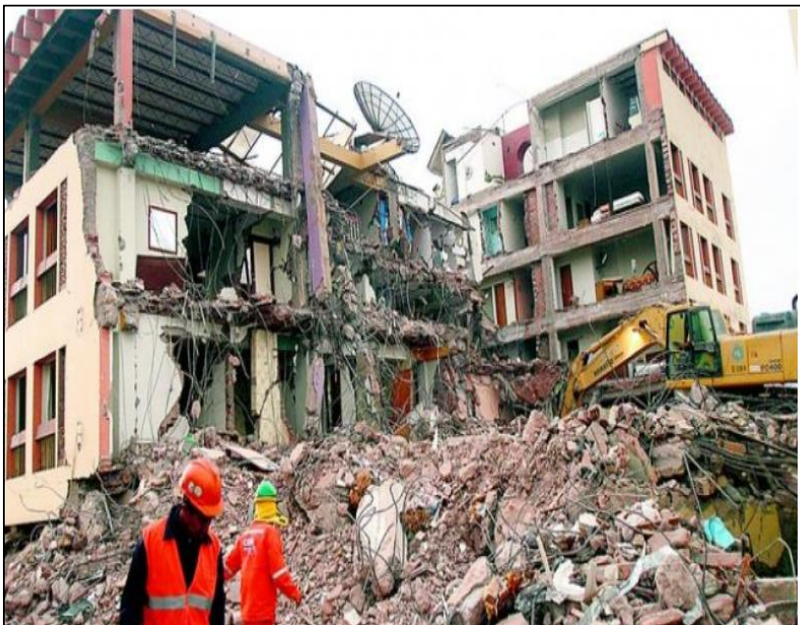
Figura 11 Sismo ocurrido en Pisco 2007.
