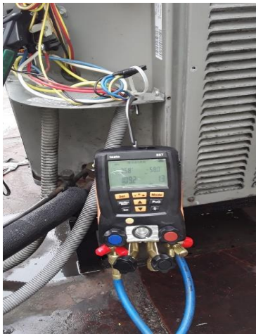
Figura 3.38 Equipo digital usado para la medición de parámetros de los equipos de aire acondicionado
