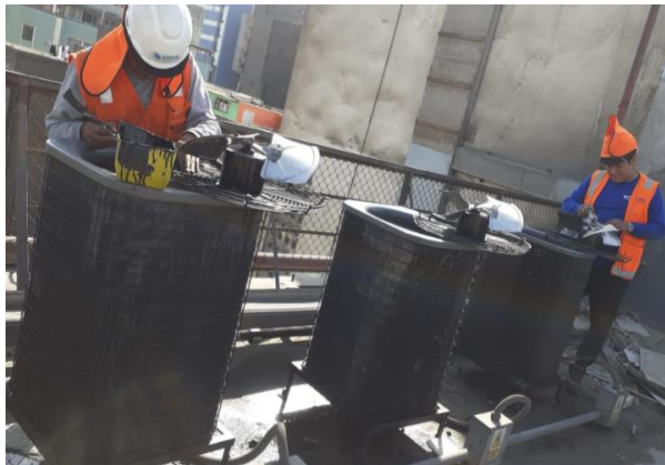
Figura 3.8 Ausencia de fichas de registro para las fallas
