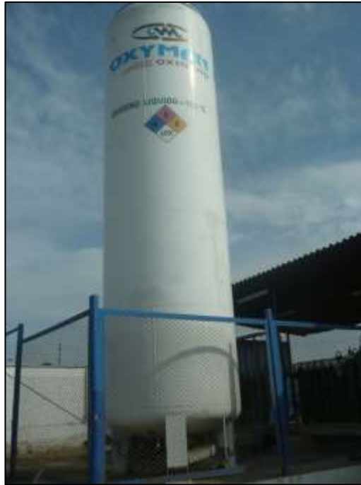
Figura 4. Tanque elevado de oxígeno. Fuente: Elaboración propia.
