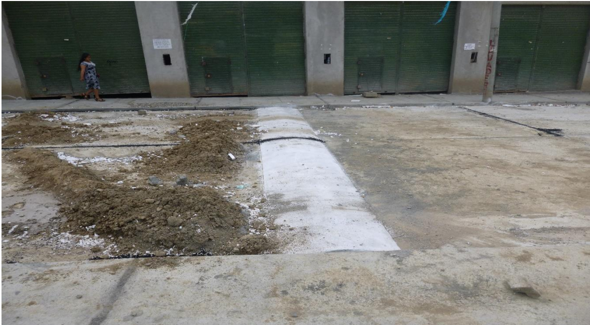
Foto 17 Vista mostrando la construcción de la giba en la calle prolongación Antisuyo..
