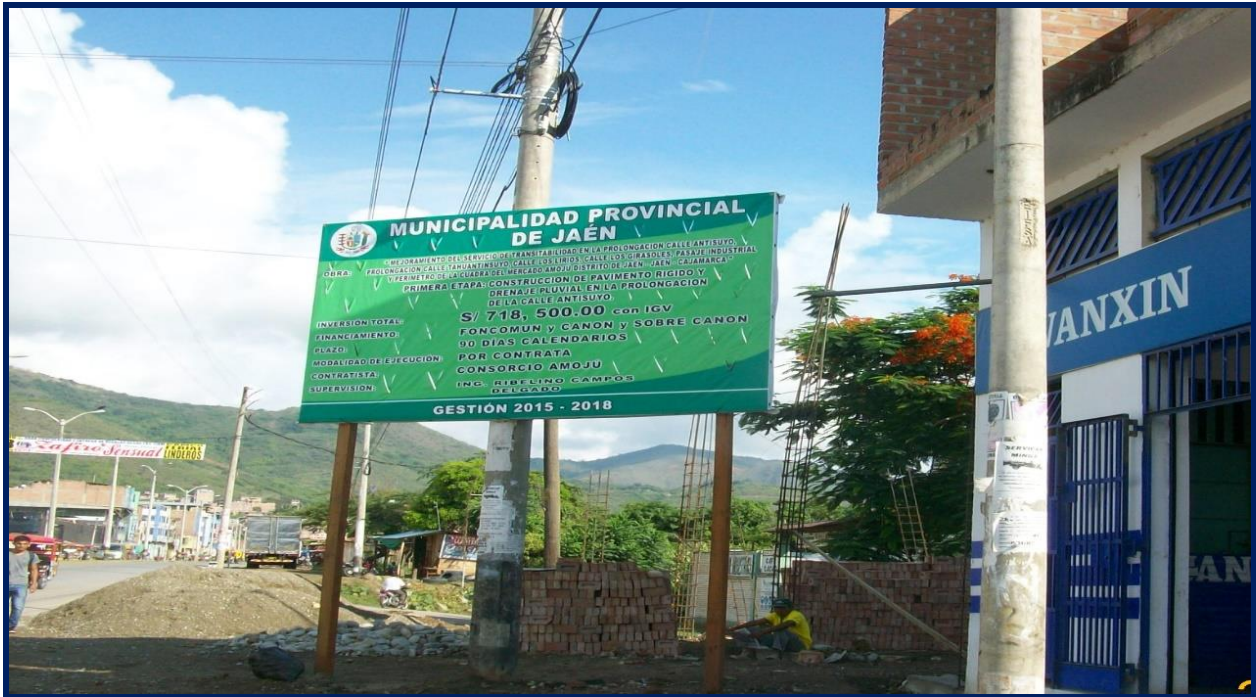
Foto 1 Cartel de identificación de obra, ubicada entre las calles Pakamuros y Prolongación calle Antisuyo
