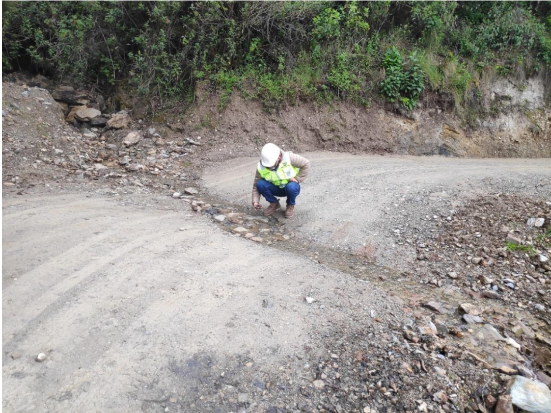
Figura 30: Impacción de los cruces de agua del Servicio de mantenimiento periódico y rutinario del camino Vecinal Emp. PE-10C(Dv. San Andres) - Huancacalla - Emp. LI-127(Llampao).
