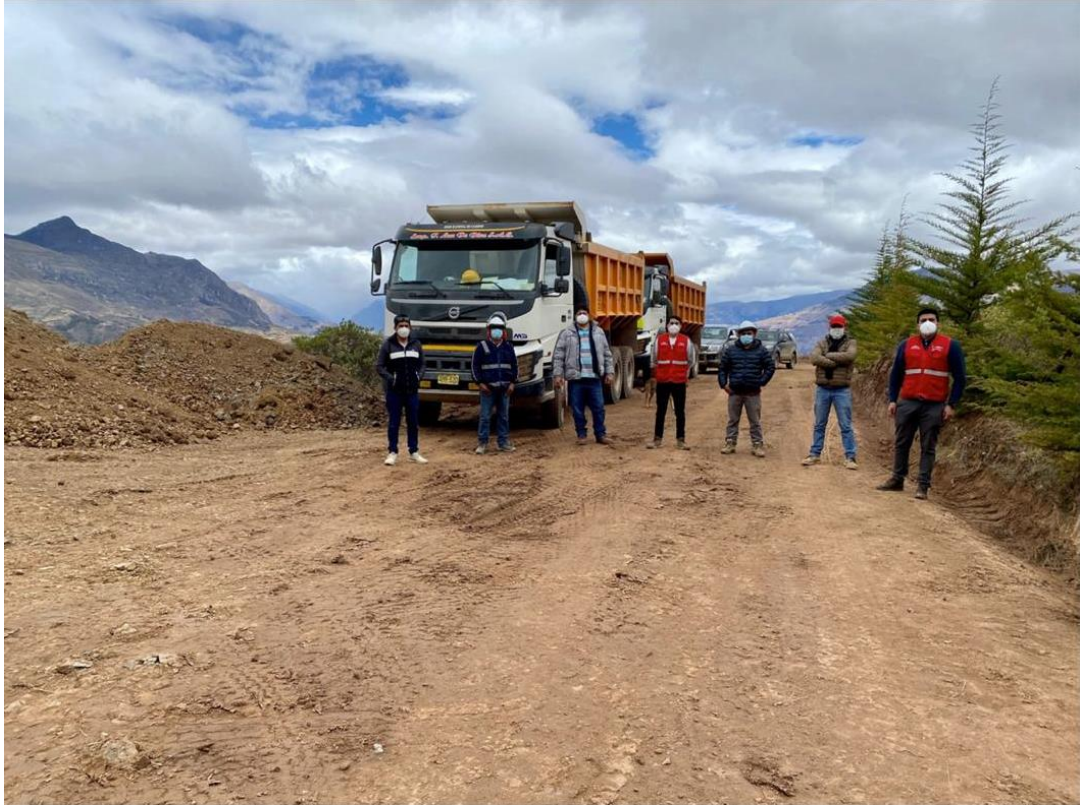
Figura 17: Impacción con el equipo técnico del Servicio de mantenimiento periódico y rutinario del camino Vecinal Emp. PE-10C(Dv. San Andres) - Huancacalla - Emp. LI-127(Llampao).
