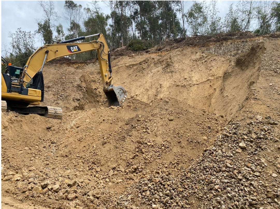
Figura 21: Impacción de las canteras del Servicio de mantenimiento periódico y rutinario del camino Vecinal Emp. PE-10C(Dv. San Andres) - Huancacalla - Emp. LI-127(Llampao).
