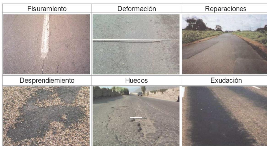
Figura 12: Daños en Pavimentos Básicos
