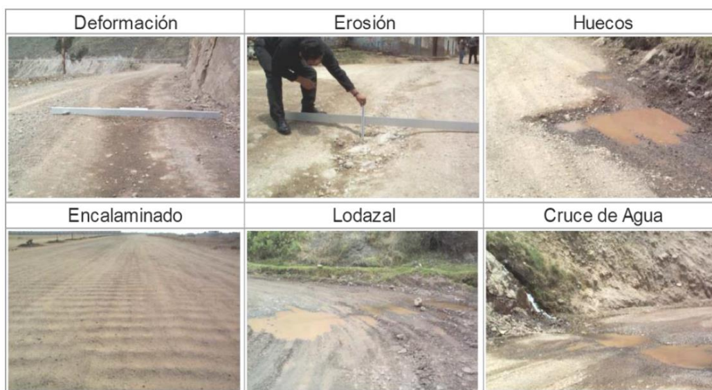
Figura 11: Daños en Carreteras No Pavimentadas
