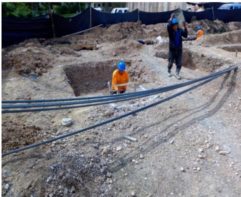
Figura 14: Vías de circulación obstaculizadas
