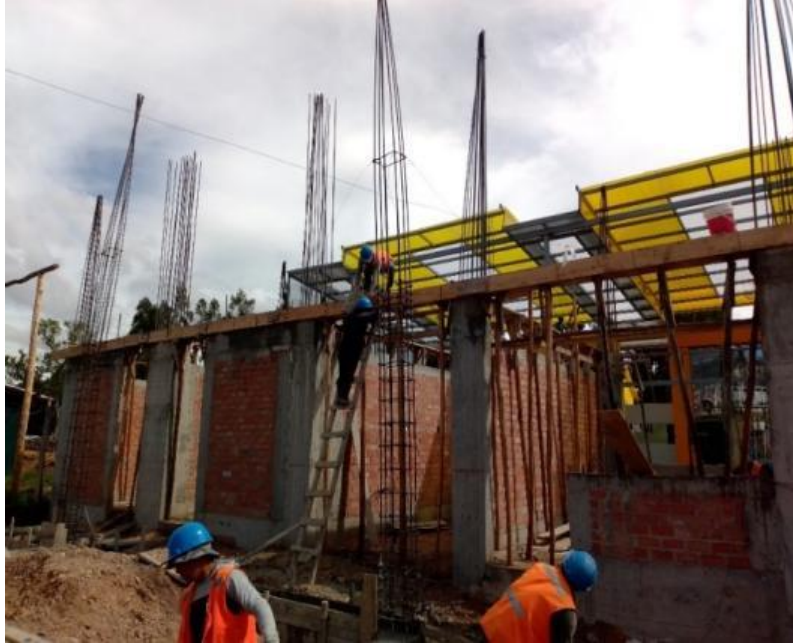
Figura 13: Trabajo en altura sin el EPP correspondiente.
