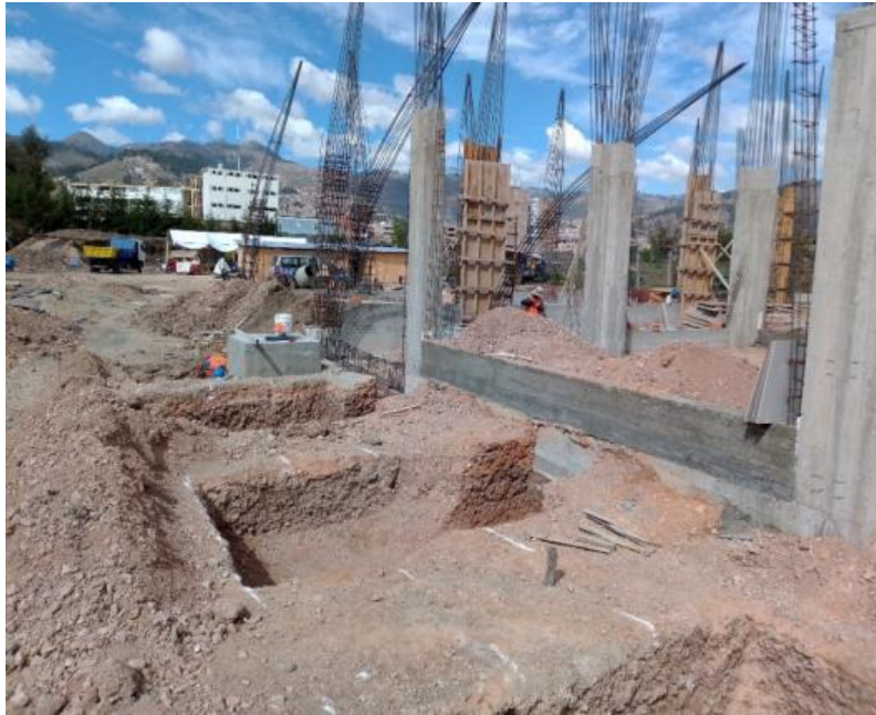
Figura 15: Falta de señalización en obra Fuente: Elaborado por Eduardo Panéz
