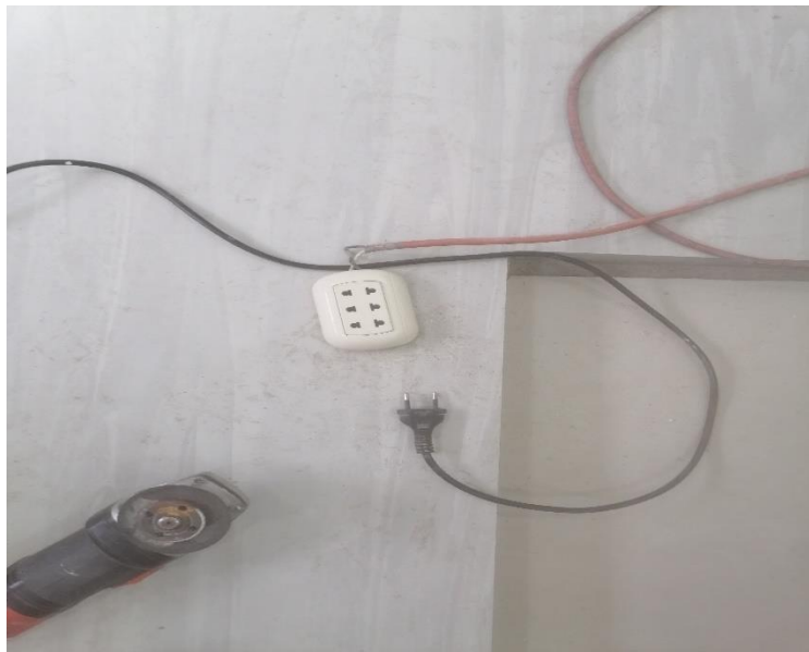
Figura 25. Extensiones eléctricas en mal estado
