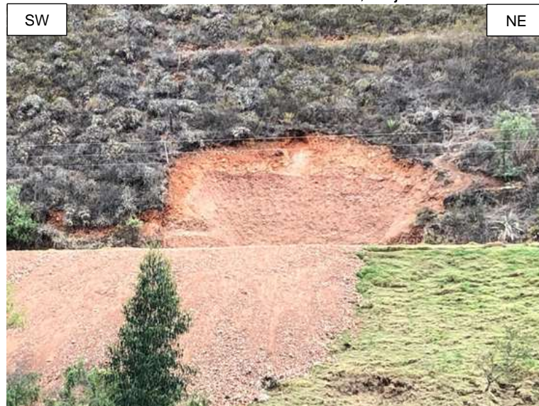
Figura 37: Deslizamiento rotacional N 9204708 E 782861 Cota 2639. Fuente: propia
