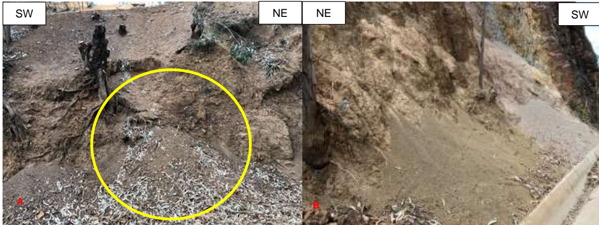
Figura 44: (A) Deslizamiento de detritos N 9204599 E 783867 Cota 2631 (B) Deslizamiento de detritos N 9204195 E 783958 Cota 2622. Ambos deslizamientos fueron encontrados en el corte de carretera CA-1494. Fuente: propia
