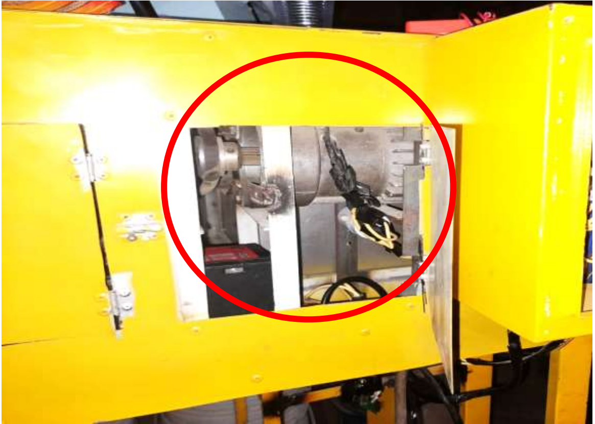
Figura 52. Ubicación del motor AC. Se encuentra en un área aislado y con una compuerta que permite que el operario revise el estado del motor para su respectivo mantenimiento.
