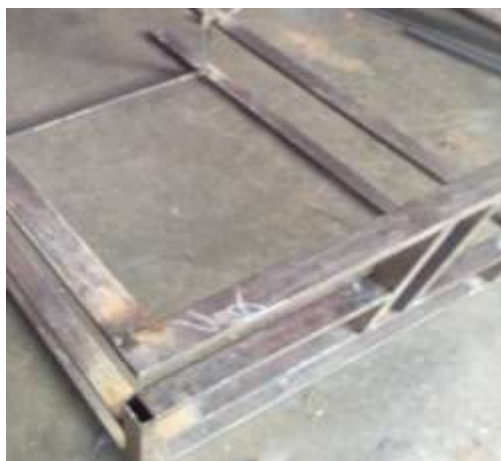
Figura 2. Esqueleto de la estructura inferior. Es la parte que soportara todo el peso de toda la estructura por lo cual es de vital importancia su análisis matemático para determinar la eficiencia del material.
