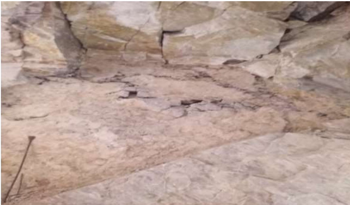
Foto 8. Rocas que van a ser desatadas.
