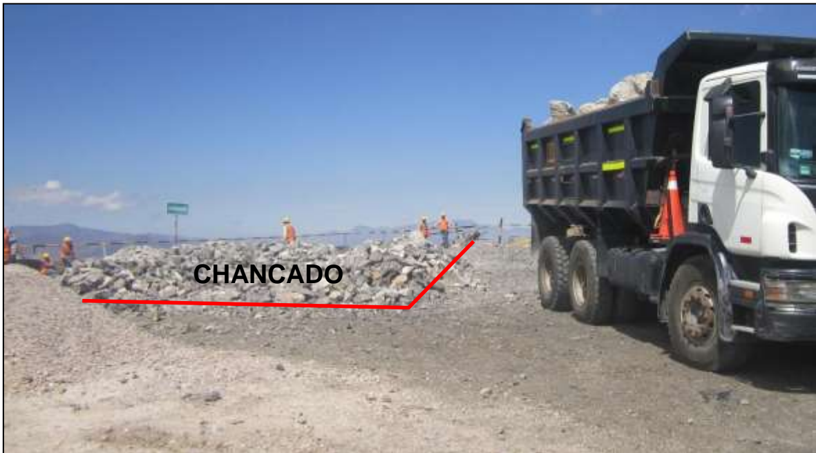
Figura 18. Zona de chancado de caliza.
