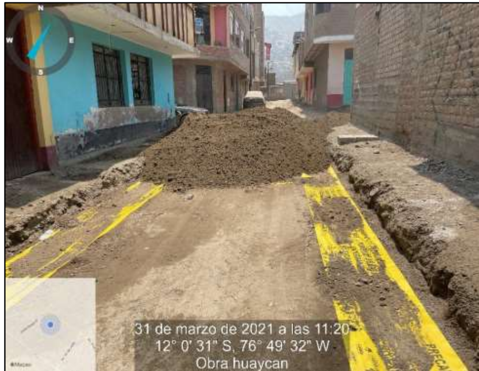
Figura 10 reposición de cinta de seguridad de gas
