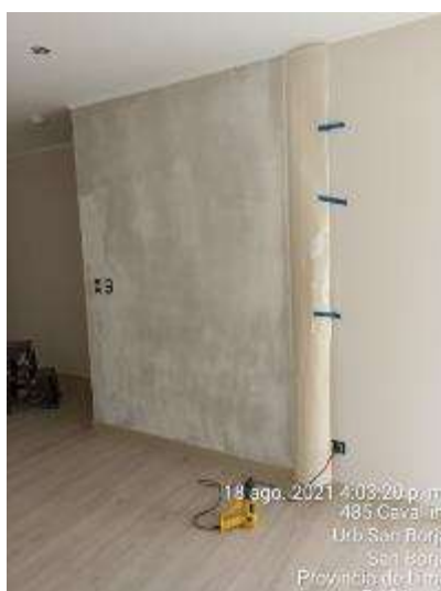
Figura 42. Observación de planeidad en muro tarrajado
