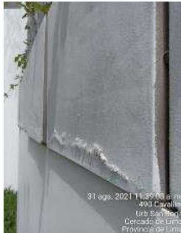
Figura 43. Observación de humedad en fachada
