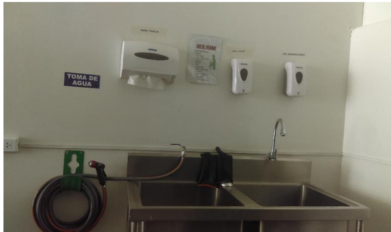
Figura 7 Espacio de lavado para los trabajadores y toma de agua
