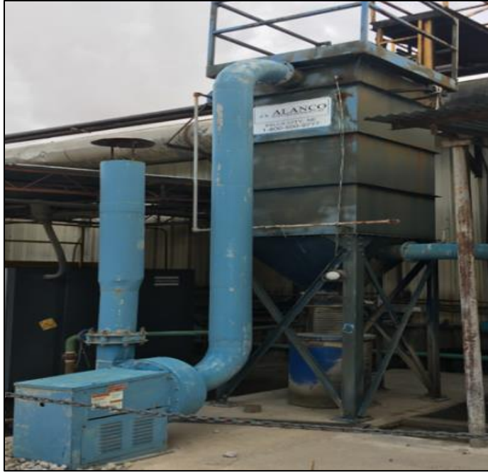
Figura 6: Colector de polvos en Planta de Calcinación
