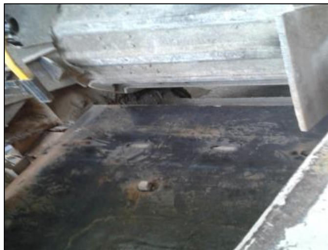
Figura 23: Plancha bajo polea motriz de Apron Feeder.
