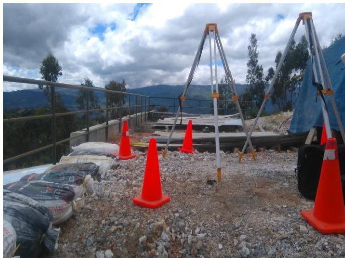
Figura 13. Equipos de monitoreo mal ubicados.
