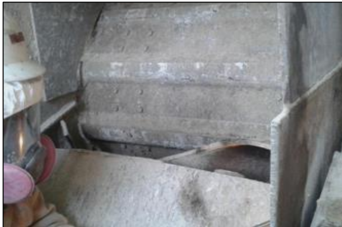
Figura 10. Plancha destrozada por polea motriz.
