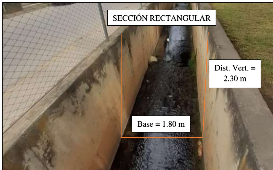
Figura 17 Foto de toma de medidas en campo del canal de la quebrada Tingomayo – Jr. Wiracocha
