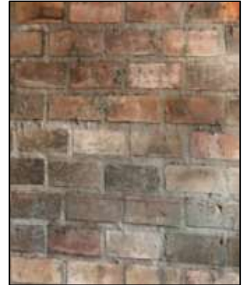
Fotografía N° 41. Juntas en muros.
