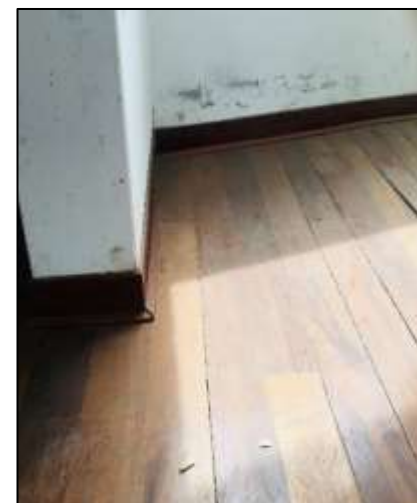
Fotografía N° 8. Juntas en piso de madera.
