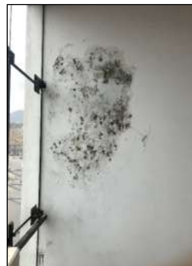
Fotografía N° 1. Moho en pintura.
