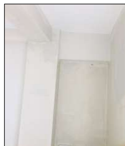
Fotografía N° 2. Decoloración de pintura.
