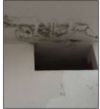
Fotografía N° 23. Desgaste de pintura.
