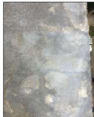
Fotografía N° 5. Grietas en piso de cemento.
