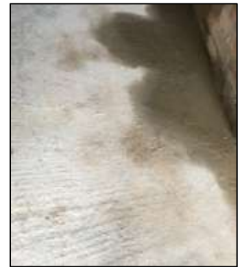
Fotografía N° 44. Infiltración de agua.
