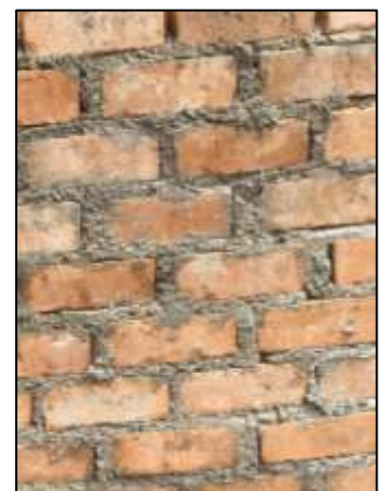
Fotografía N° 32. Juntas en muros.
