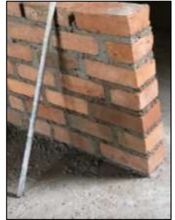
Fotografía N° 29. Juntas en muros.
