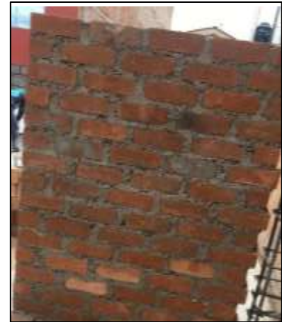
Fotografía N° 11. Juntas muros de albañilería.
