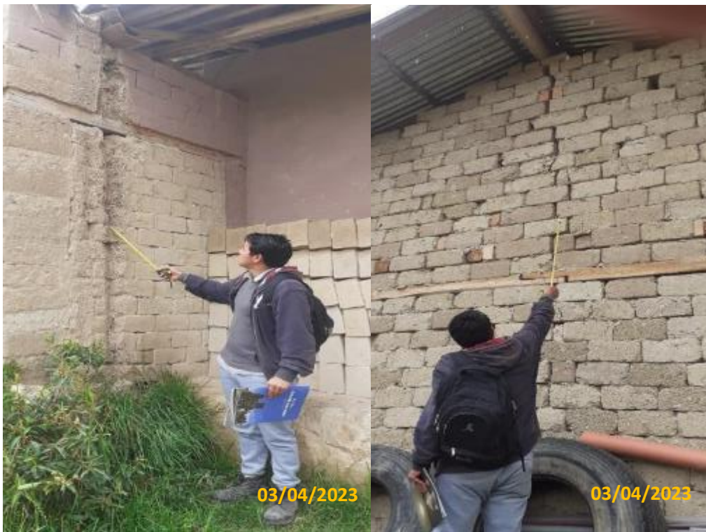
Nota: Fallas en las viviendas del caserío Frutillo Bajo producto de las Lluvias.
