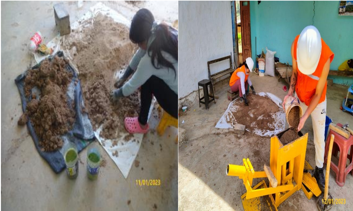
Nota: Realizando la mezcla de los materiales para la elaboración de los adobes.
