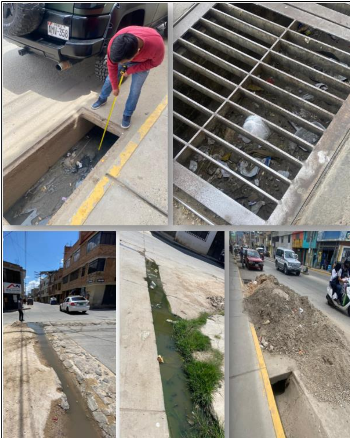
Figura 48. Existencia de sedimentos en los diferentes canales de drenaje pluvial de la zona.
