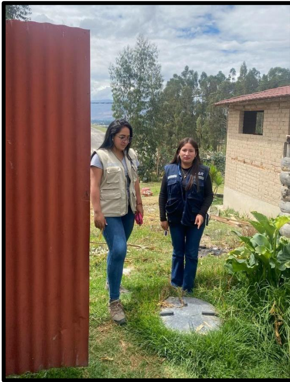
Biodigester en buen estado físico y operatividad.
