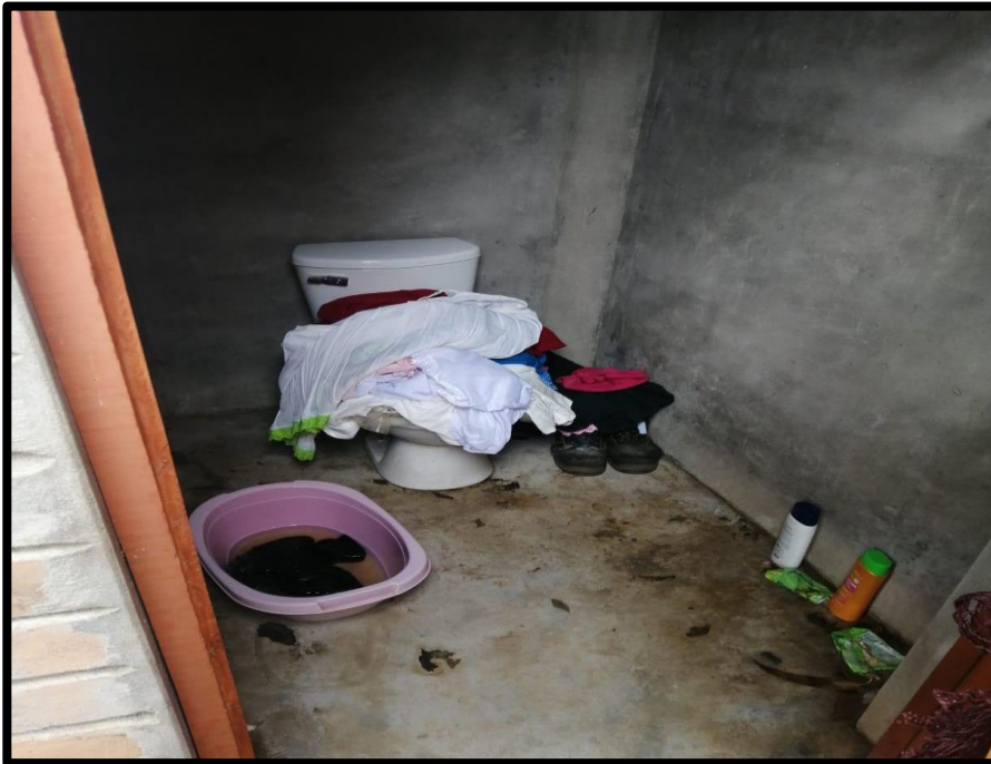
Unidad básica de saneamiento con malos aspectos de higiene.
