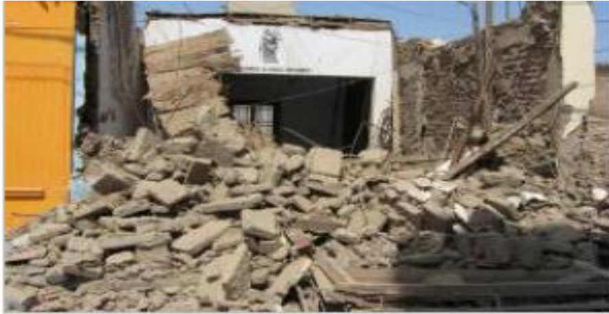
Figura 3. Muestra el colapso de viviendas de adobe producidas por el Terremoto de Pisco.
