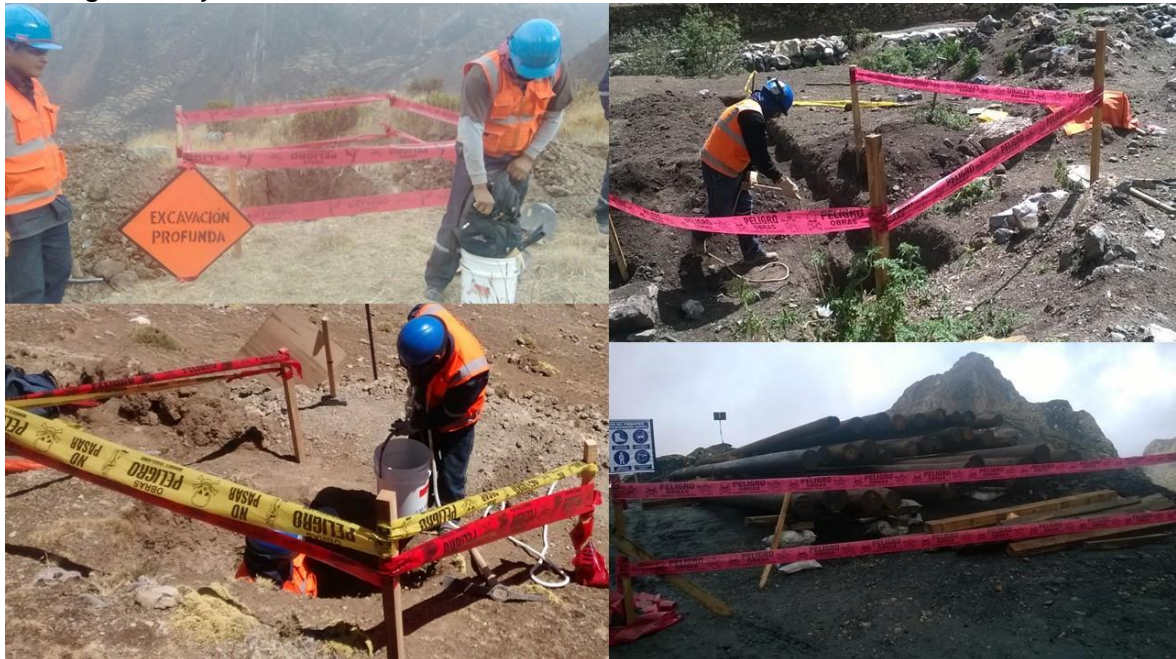
Figura n.º 24, En todas las áreas de trabajo se está trabajando con las medidas de seguridad y señalización adecuada.
