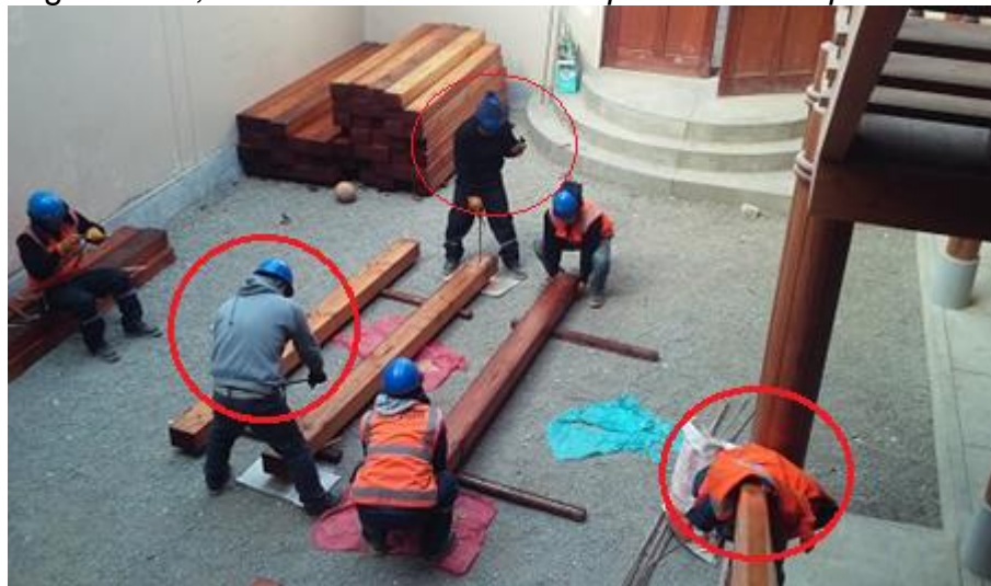
Figura n.º 9, Uso inadecuado de EPP por falta de capacitación
