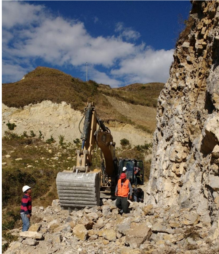
Verificación del uso de EPP básico en la obra, “Mejoramiento del Camino Vecinal Puente Cangana – Rambrampata”.
