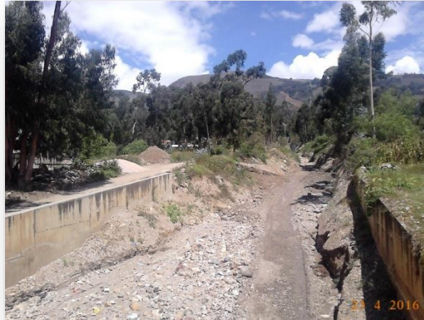
Imagen N° 9. Situación actual parte media de la quebrada Cruz Blanca.
