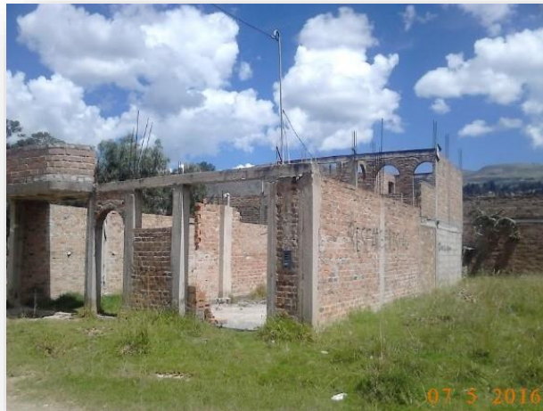
Imagen N° 30. Vivienda abandonada en el Lote 2010 de la zona de estudio.
