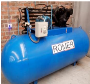
Compresor de aire
