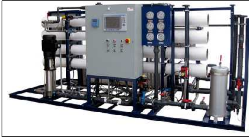
Figura nº. 2-7. Equipo de osmosis inversa industrial.
