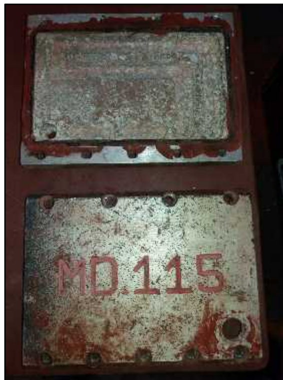
Figura n°. 3-13. Chaquetas de enfriamiento molinos de borde obstruidas.
