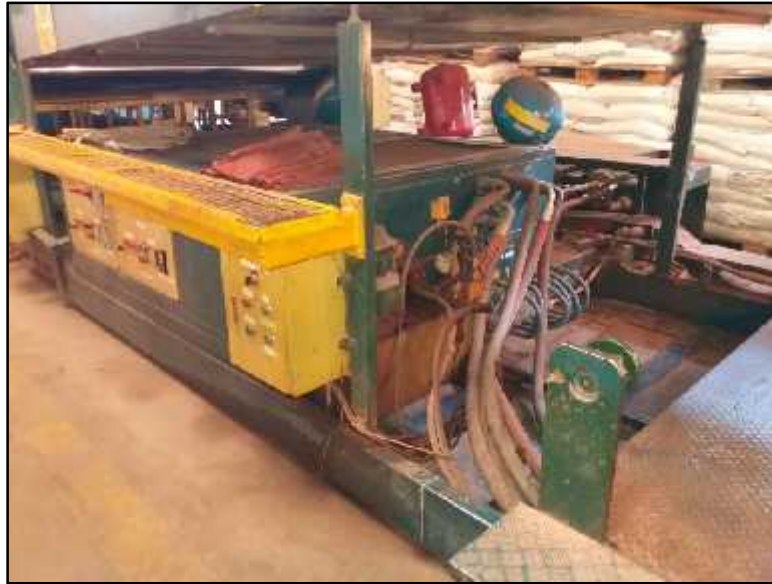
Figura nº. 1-1. Central de termorregulación (CTR).
