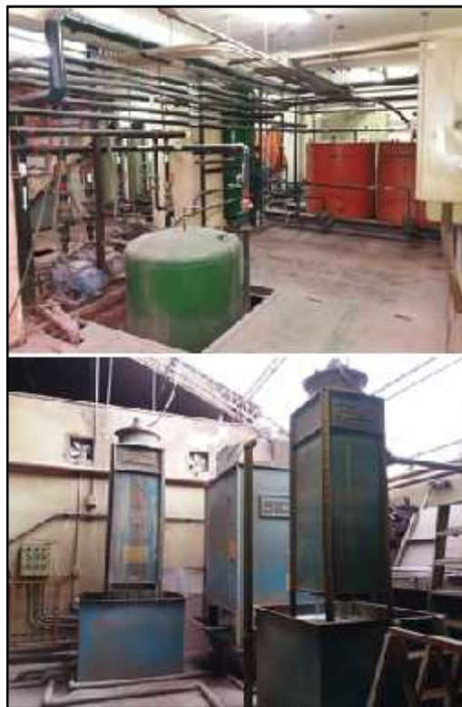
Figura nº. 3-7. Sala de bombas y torres de enfriamiento – Industrias Fibrforte S.A.
