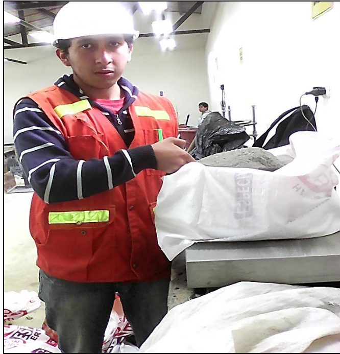
Fotografía 07: Peso de las cantidades de materiales para realizar la mezcla de concreto
