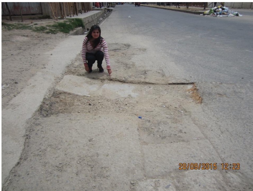
Figura N°. 32: Evaluación Funcional:Destrucción parcial de la carpeta asfáltica
