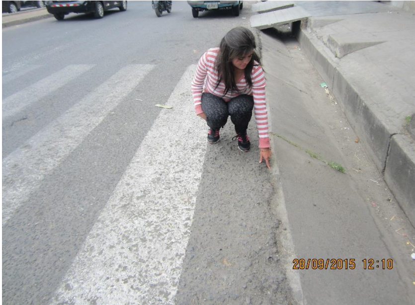
Figura N°. 31: Evaluación funcional de la vía: Fallas de borde
