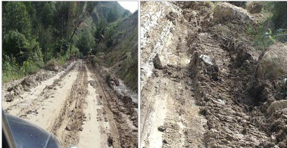
Figura 2. Mal estado de la carretera a Combayo
