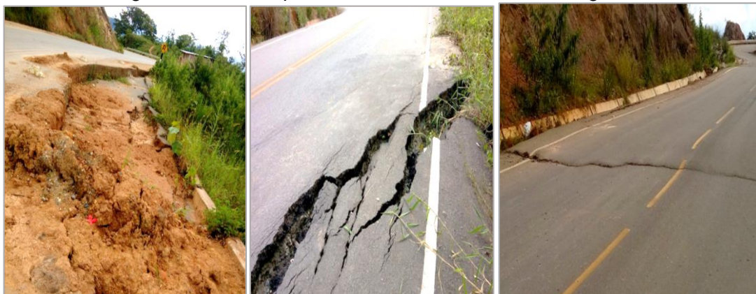
Figura 3. Falla del pavimento de la carretera a San Ignacio
