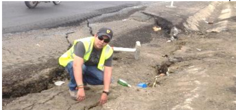
Figura 1. Asentamiento de la vía Rocafuerte a causa de arcillas expansivas
