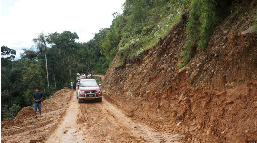
Foto 1. Carretera afirmada deteriorada
