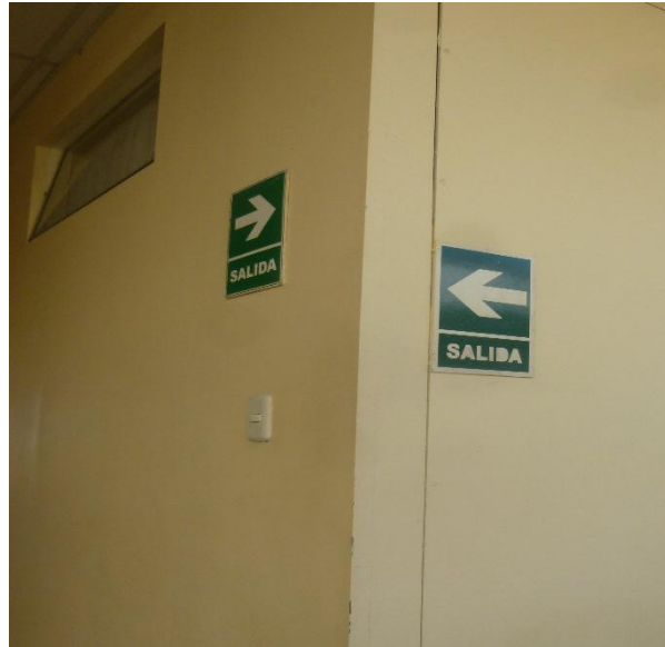
Figura N° 7: Señalización de evacuación UPNC
