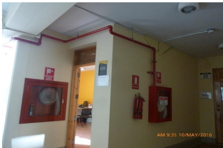
Figura N° 5: Gabinete contra incendio frente al auditorio UPNC
